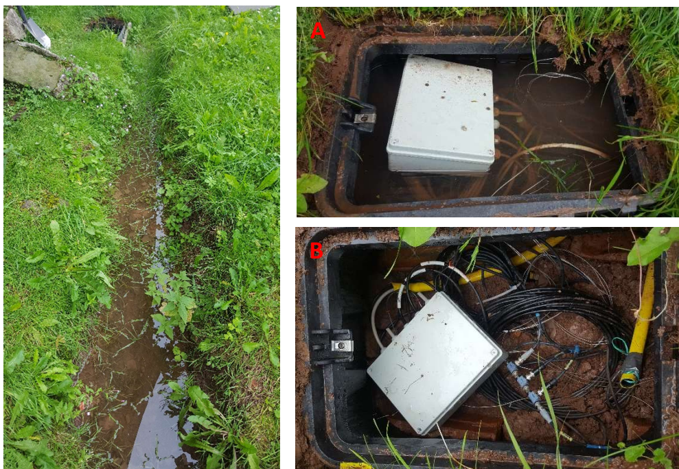
Obr. 35 Stav strouhy a šachtice po dešti
