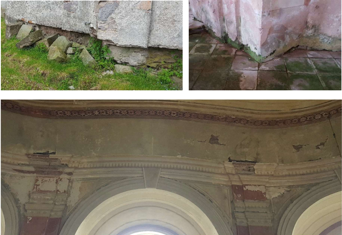
Obr. 12 Poškození stěn kostela v exteriéru (vlevo nahoře), u podlahy v interiéru (vpravo nahoře) a římsy pod stropem (obrázky dole)
