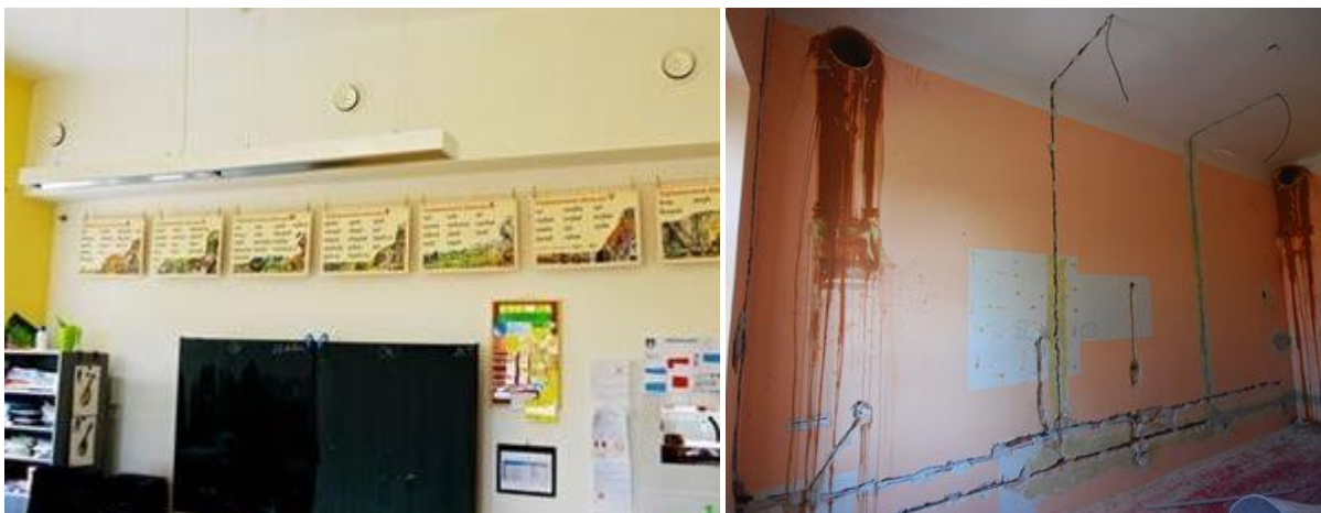
Obr. 16 Přívodní distribuční prvky a stavební úpravy spojené s rozvody vzduchotechnického potrubí (Atrea, 2012)
