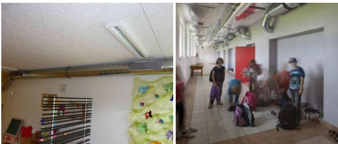
Obr. 17 Rozvody vzduchotechniky a distribuční prvky ve třídě (Renew school, 2017)
