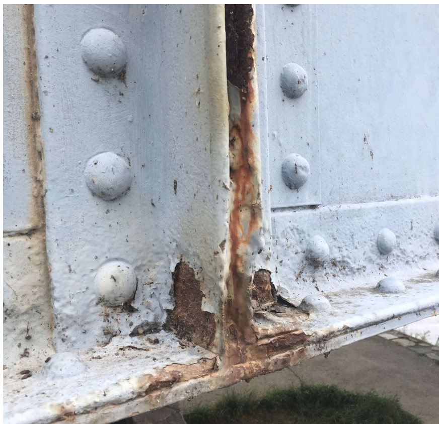
Obrázek 20 Korozní oslabení svislíce u dolního pásu (Týn nad Vltavou, Česká republika)
