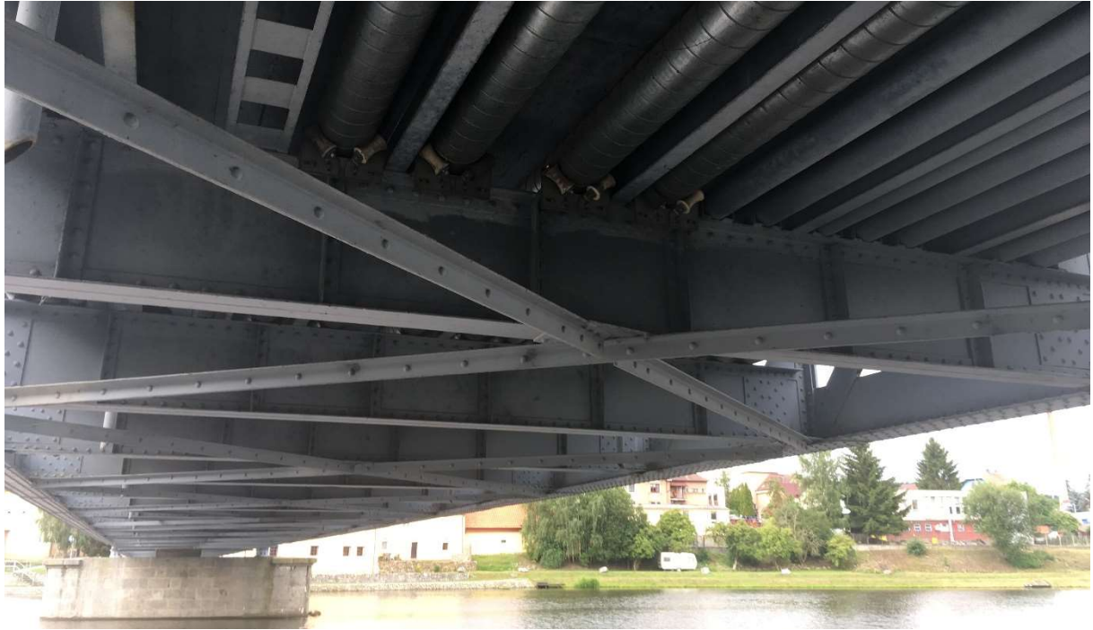
Obrázek 11 Spodní vodorovné ztužení (Týn nad Vltavou, Česká republika)
