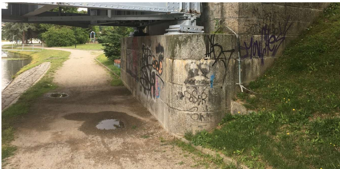
Obrázek 24 Opěra 3, poškození graffiti (Týn nad Vltavou, Česká republika)
