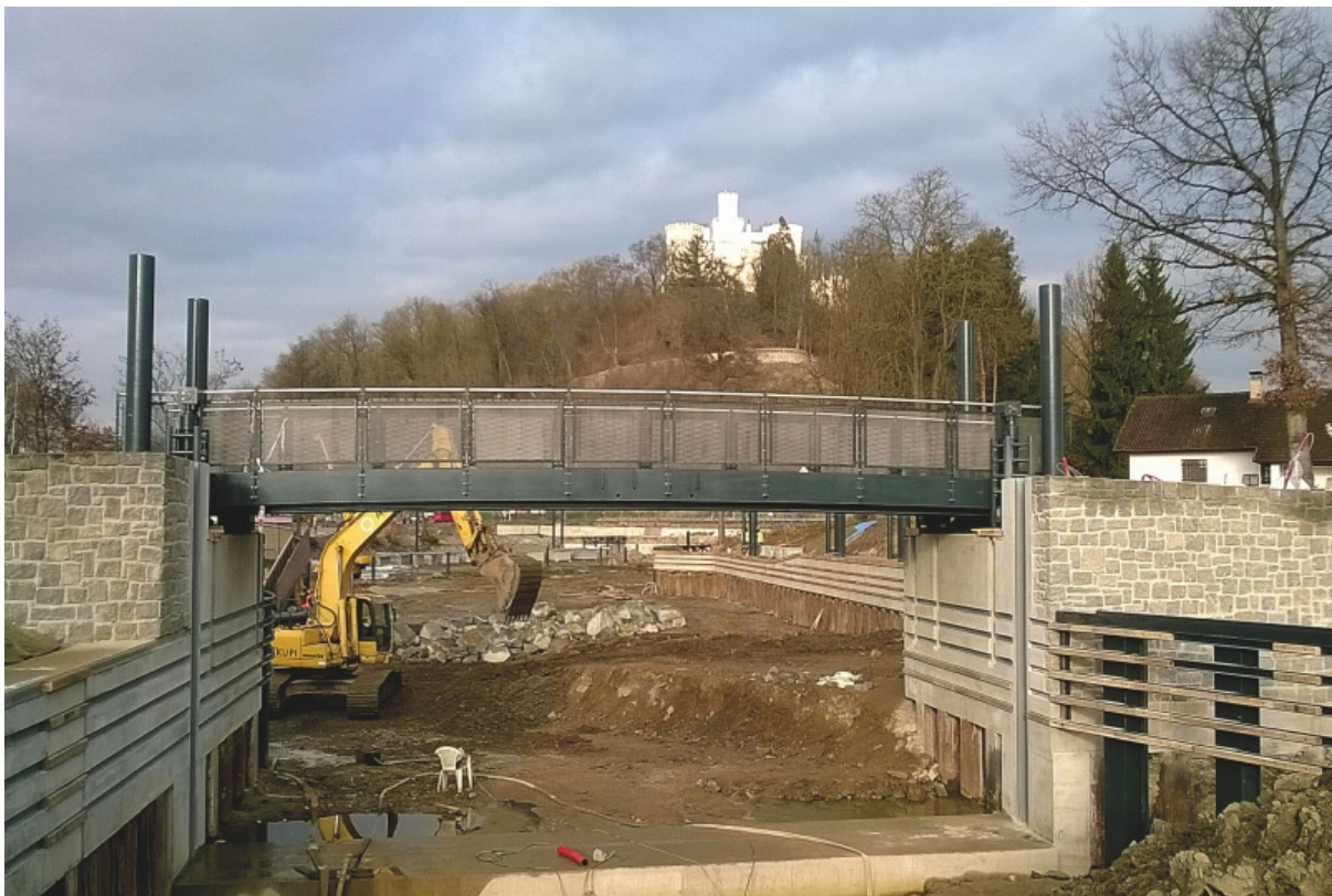
Obrázek 17 Zdvihací lávka s vodicími pylony (Hluboká nad Vltavou, Česká republika)
