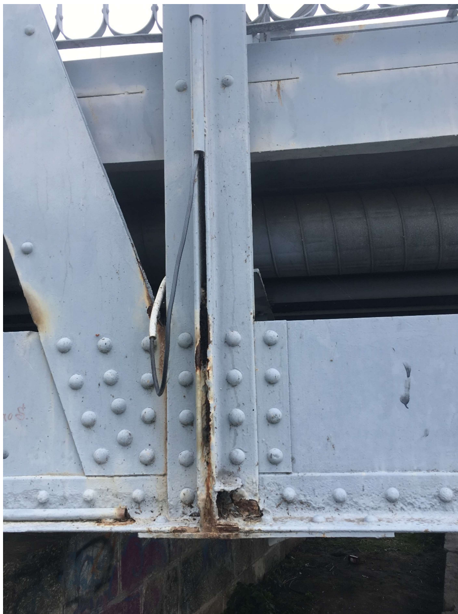
Obrázek 31 Styčník dolního pasu poškozený korozí, u opěry O1
