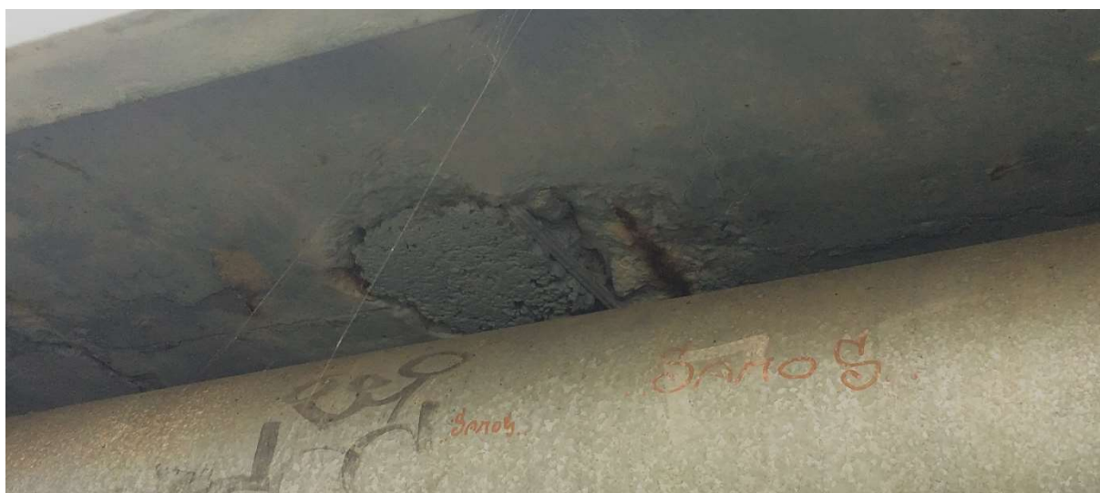
Obrázek 23 Degradovaný beton desky mostovky (Týn nad Vltavou, Česká republika)
