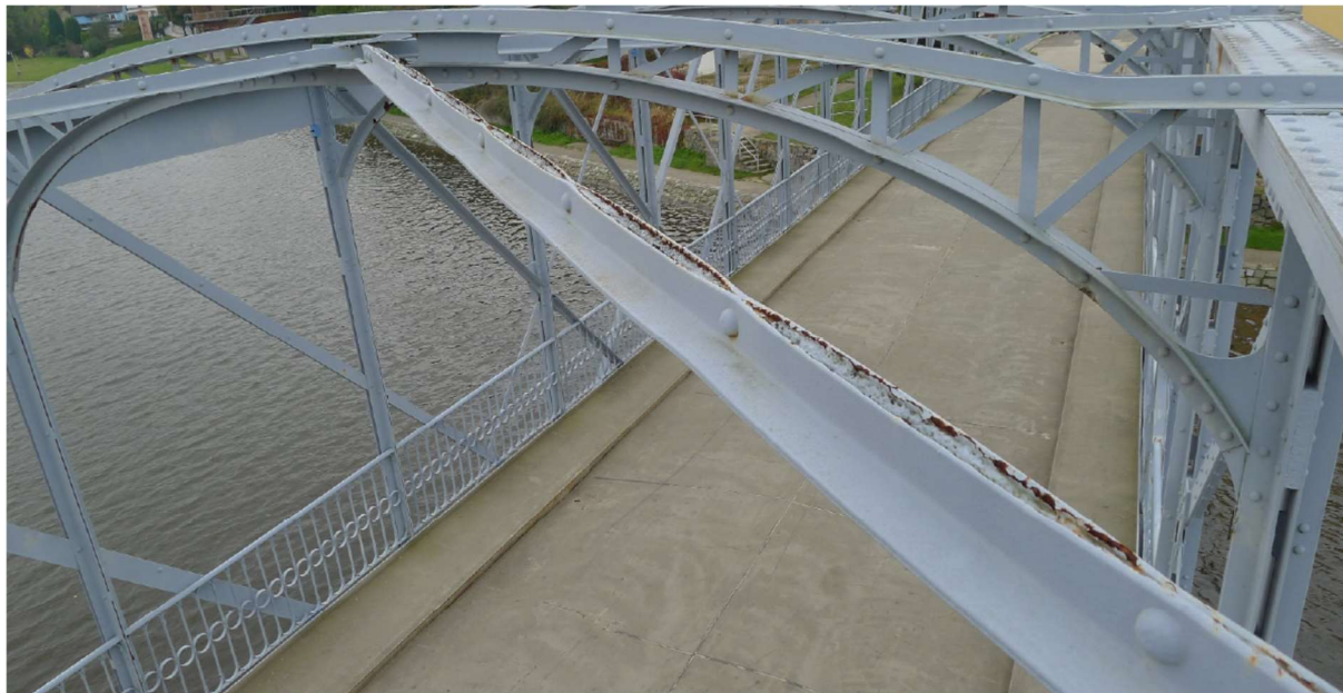
Obrázek 22 Rozevírání a koroze úhelníků horního ztužení (Týn nad Vltavou, Česká republika)
