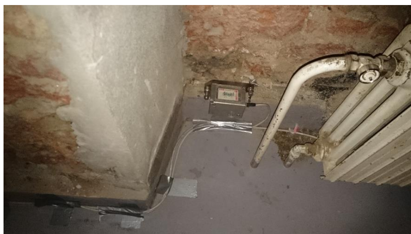
Obrázek č. 36: Osazení indukčního snímače rychlostí v objektu Vily Štvanice (foto poskytnuto firmou INSET s.r.o.)
