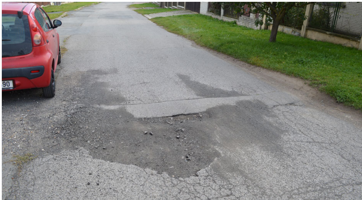
Obr. 31: Ulice Úhlavská - výtluky
