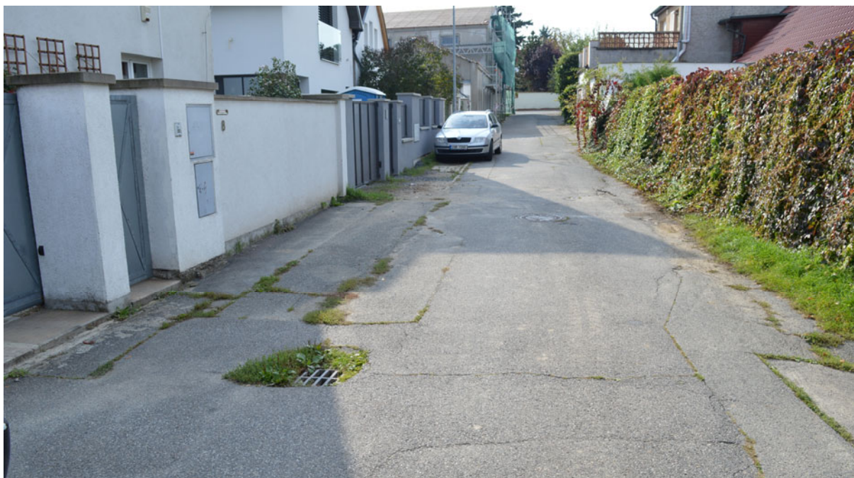
Obr. 9: Ulice Hřbitovní – poškození vozovky
