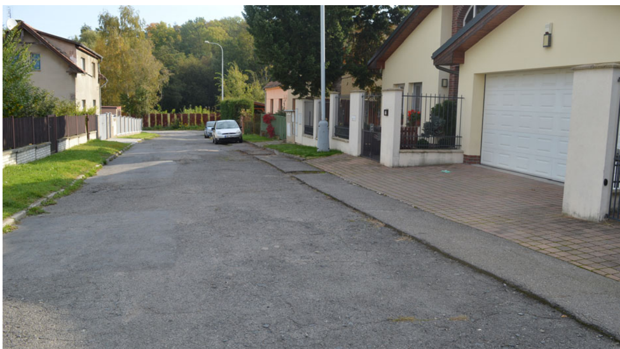
Obr. 26: Ulice Labská – pohled na KÚ1 – nerovnoměrné sedání
