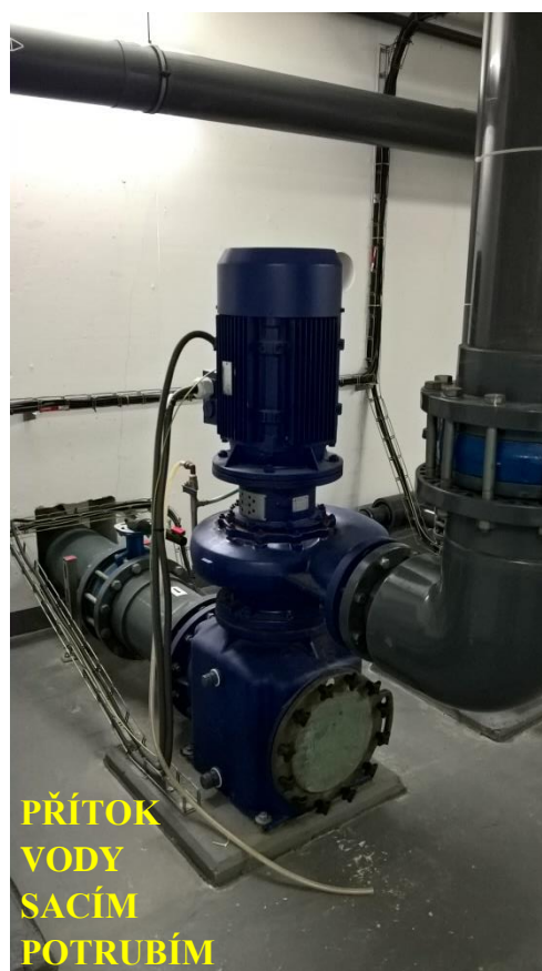
Obr. 8.64 – Sací potrubí [ŠVEJDOVÁ, Nikola. © 2017.]
