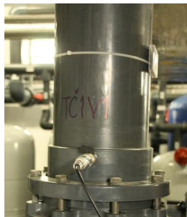
Obr. 8.19 – Tlakové čidlo na výtlaku TČ1V1
