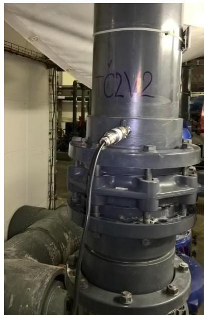
Obr. 8.26 – Tlakové čidlo na výtlaku TČ2V2 [ŠVEJDOVÁ, Nikola. © 2017.]
