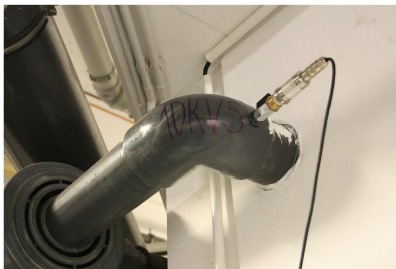
Obr. 8.77 – Tlakové čidlo na výtlaku 1DKV5 (detail) [ŠVEJDOVÁ, Nikola. © 2017.]
