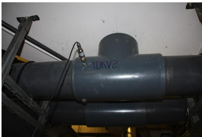
Obr. 8.67 – Tlakové čidlo na výtlaku 1DKV2 (detail) [ŠVEJDOVÁ, Nikola. © 2017.]
