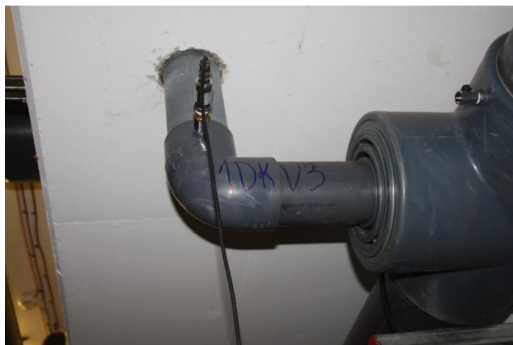
Obr. 8.72 – Tlakové čidlo na výtlačku 1DKV3 (detail) [ŠVEJDOVÁ, Nikola. © 2017.]
