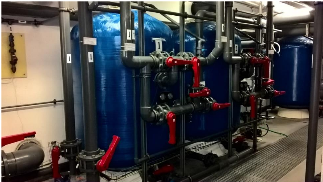
Obr. 7.17 – Pískové filtry [ŠVEJDOVÁ, Nikola. © 2017.]
