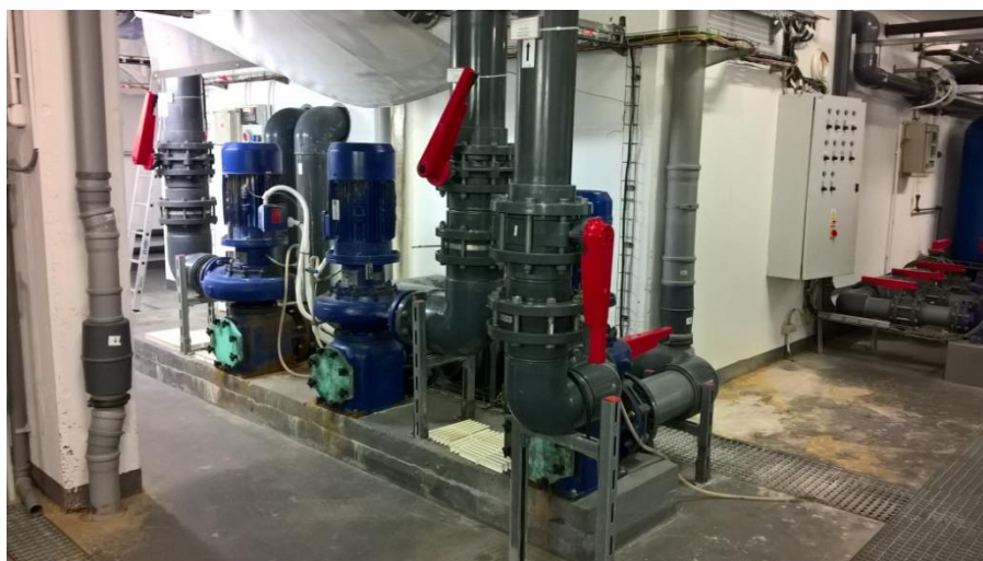
Obr. 7.10 – Dvě čerpadla BADU ® Block 125/250 [ŠVEJDOVÁ, Nikola. © 2017.]
