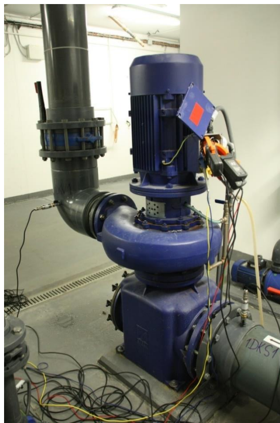
Obr. 8.58 – Tlakové čidlo na sání 1DKS1 [ŠVEJDOVÁ, Nikola. © 2017.]
