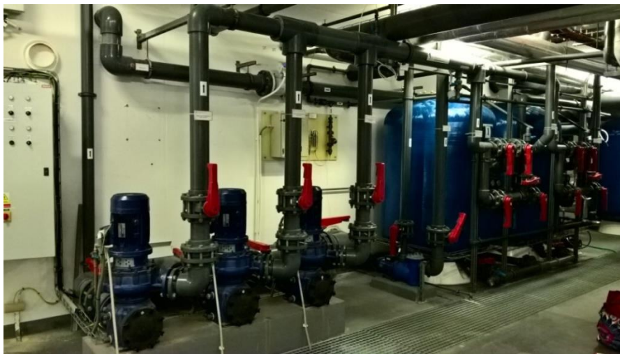
Obr. 7.13 – Úpravna vody tobogánu a troj skluzavky [ŠVEJDOVÁ, Nikola. © 2017.]
