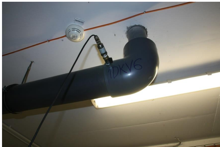
Obr. 8.81 – Tlakové čidlo na výtlaku 1DKV6 (detail) [ŠVEJDOVÁ, Nikola. © 2017.]
