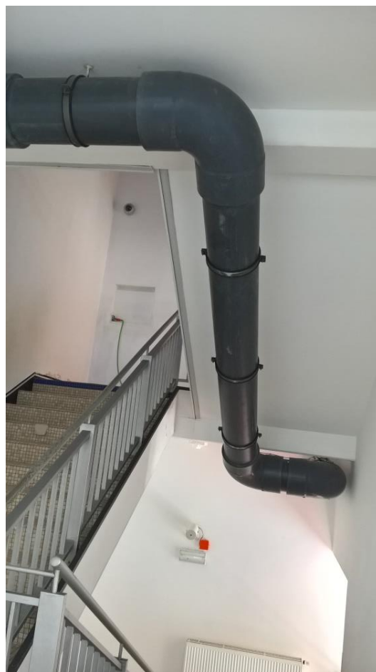
Obr. 8.31 – Výtlačné potrubí tobogánu mimo strojovnu 1
