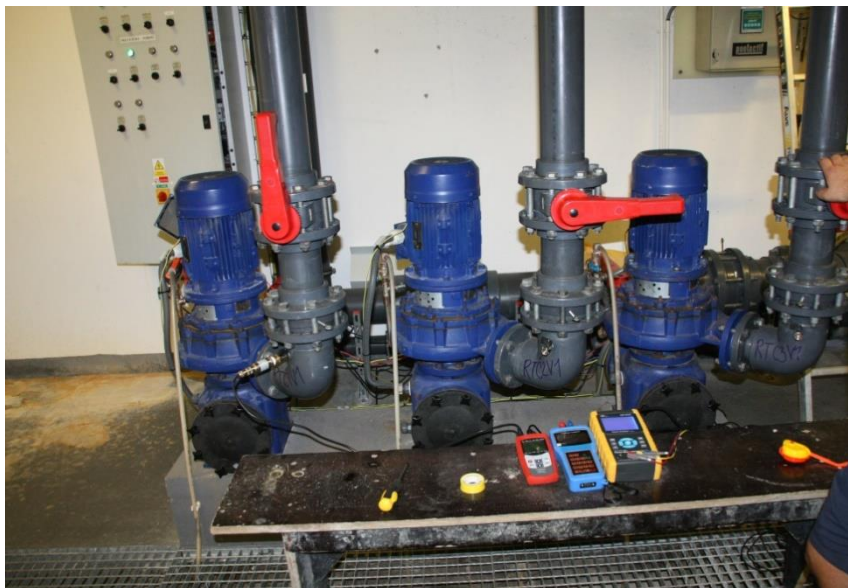
Obr. 8.48 – Čerpadlo Č 1 [ŠVEJDOVÁ, Nikola. © 2017.]
