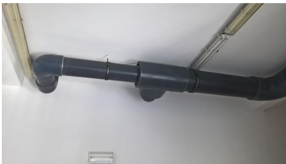
Obr. 8.32 – Výtlačné potrubí tobogánu mimo strojovnu 2
