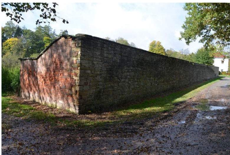
Foto 22 Cihelná zeď pod zástavbou
