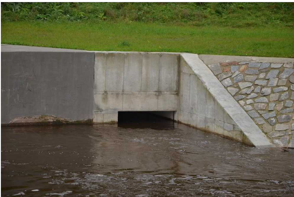
Obrázek 2.7 Nejnovější úprava na Zličském jezu – obtokový kanál v levém pilíři
