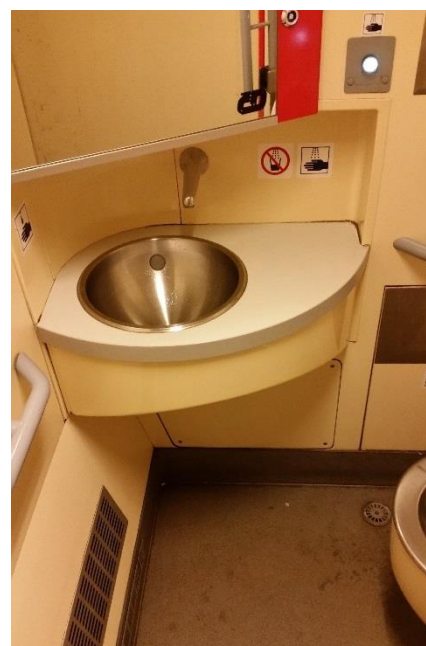
Obrázek 132: Prostor okolo umyvadla je nevhodně řešen, protože je okraj umyvadla vyvýšen, a naopak vyvýšení chybí na okraji desky. Voda rozstříkovaná na ostěni za umyvadlem a na desku okolo umyvadla tak nestéká zpět do umyvadla, ale teče na podlahu. Zde jsou již vidět nánosy nečistot a plísň v hraně mezi deskou a stěnou. Dalším problémem je, že stékající voda teče do mřížky umístěné na stěně pod umyvadlem, kde je pravděpodobně umístěné topení. Voda bude tento prostor degradovat a zanášet špínou. Takovýmto chybám v návrhu je potřeba se vyhnout.
