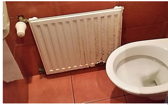
Obrázek 133: Problematické umístění topení na stěně vedle toalety. Rozstříkující se kapičky tekutiny na pánských záchodech se usazují na stěně a topení a topení v tomto místě koroduje. Stěny vedle mísy musejí být na tento jev připraveny a musejí být v dostatečné vzdálenosti od mísy, aby umožnily snadné čištění.
