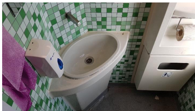
Obrázek 122: Nevhodně řešené umyvadlo, kde rozstříkující se voda stéká podél umyvadla na podlahu. Papírové utěrky na sušení rukou jsou nevhodně umístěny nad toaletním papírem, takže při sušení rukou dochází k namáčení toaletního papíru.
