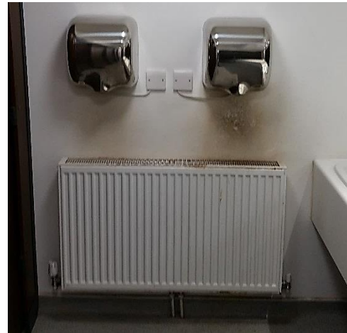
Obrázek 130: Velmi nevhodné umístění sušiče rukou, kdy voda z rukou kape na podlahu, na stěnu a přímo do topení, které pak koroduje. Po chvíli provozu vypadá tento prostor velmi nevábně a zašle i když je zrekonstruovaný. Takováto chyba se na toaletě ve vlaku stát neměla. Topení by se na toaletu spíše umísťovat nemuselo, sušák musí být umístěn tak, aby voda při přesunu rukou z prostoru umyvadla do prostoru sušáku kapala jen do prostoru umyvadla, případně dovnitř sušáku, odkud bude svedena do odpadu. Při sušení musí sušák sfouknutou vodu sbírat a odvádět do odpadu.
