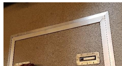
Obrázek 45: Kontrolní poklop v podlaze vozidla. V rozích dochází k ohýbání ochranných lišt a bude docházet k postupné degradaci. Poklopům v podlaze je lepší se vyhnout.
