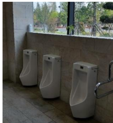
Obrázek 97: Pisoáry na pánských toaletách. Ve vlaku by měly být pánské toalety také doplněny pisoárem pro zvýšení čistoty toalety a pro úsporu vody při splachování.
