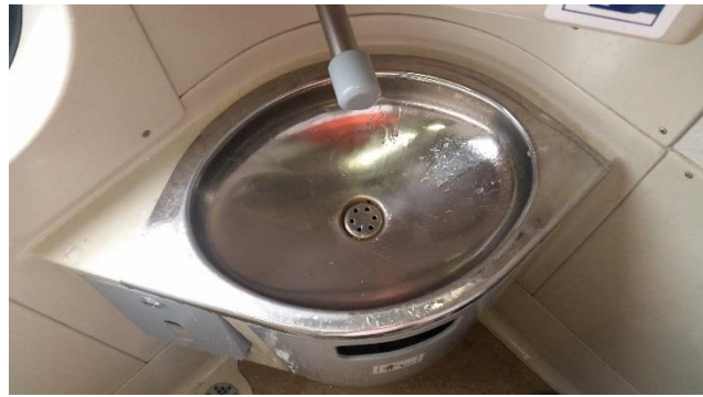
Obrázek 120: Umyvadlo je sice vhodně zasazeno do rohu toalety, ale stěna za umyvadlem má přesně v místě, kam ještě budou stříkat kapky vody z umyvadla spáru mezi panely, která půjde špatně čistit. Dále je umyvadlo nevhodně řešeno tak, že všechna voda, která je vystříknuta na stěnu za umyvadlem steče podél umyvadla a poté po stěně na zem, místo aby byla svedena zpět do umyvadla. Na obrázku voda stéká na zásobníky s toaletními potřebami a na kovový kryt koše, který pak koroduje. Umyvadlo by nemělo být lemováno zvýšeným okrajem, ale umyvadlová deska by měla mít na okraji zvýšenou hranu a měla by mít sklon směrem do umyvadla, aby vycákaná voda stekla zpět do umyvadla.
