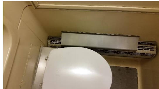
Obrázek 134: Naprosto nevhodné uspořádání toalety, kdy je nejen toaletní mísa umístěna příliš blízko boční stěny, takže by se prostor vedle ní špatně čistil, ale dokonce je vedle ní umístěno topení s množstvím otvorů do kterého budou při používání toalety zatékat kapky tekutiny a bude se zanášet nečistotami. Dopravce se tento zásadní problém snažil omezit tím, že nad topení umístil nerezovou střešku, ale toto stále neřeší problém s úklidem. Do místa vedle toalety nesmí být nikdy umístěno topení a pokud už dopravce požaduje vytápět toaletu, tak by bylo lepší pro vytápění použít vzduchotechniku. Lišta na stěně také nepřispívá k lehčení úklidu.
