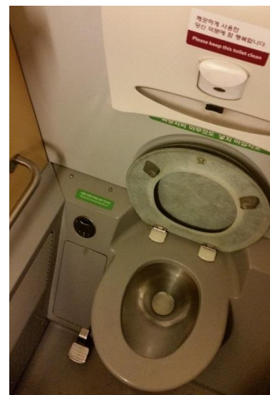
Obrázek 116: Rotem KTX KORAIL. Nášlapné tlačítko pro ovládní splachování toalety. Jedná se o jednoduchý a hygienický způsob ovládní, ale v době elektronických senzorů již o způsob zastaralý.
