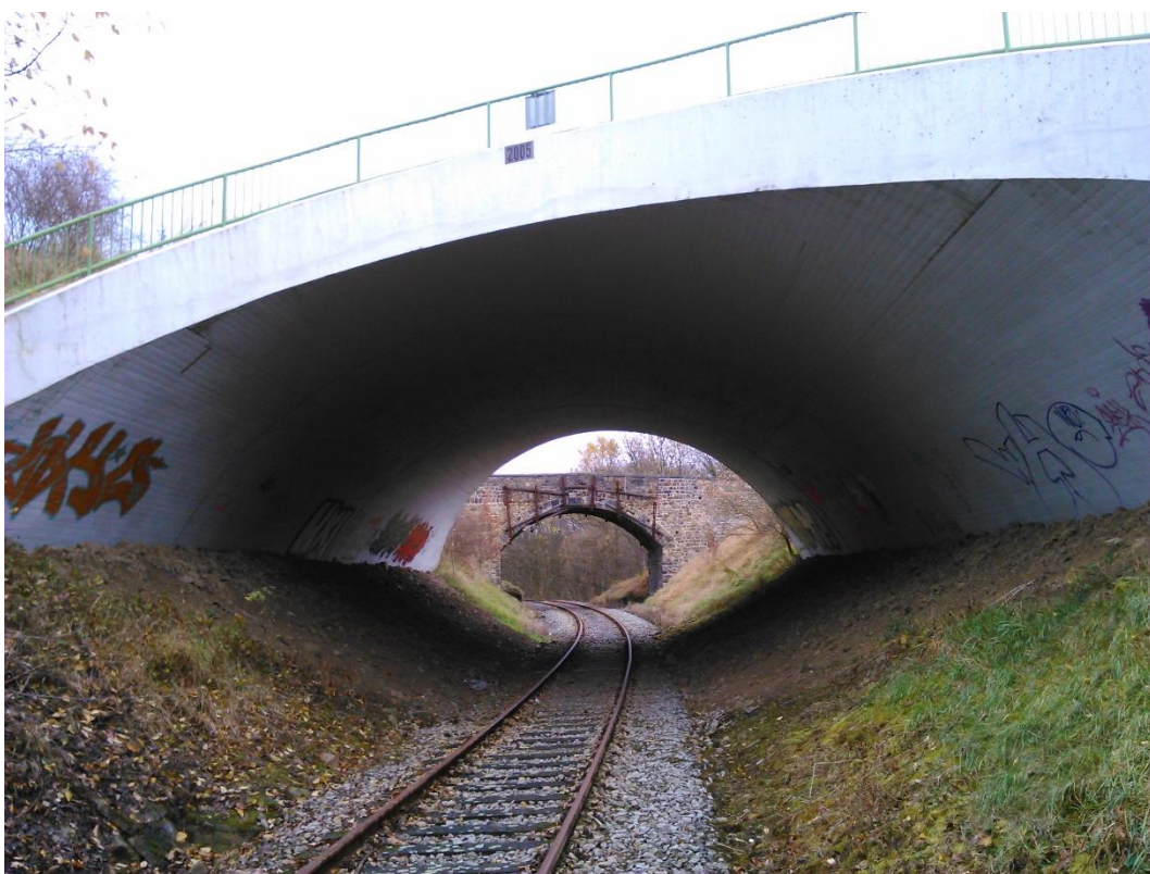
Foto 12 - Silniční nadjezd silnice II/528 v oblasti Žďárku, v pozadí původní nadjezd z roku 1895
