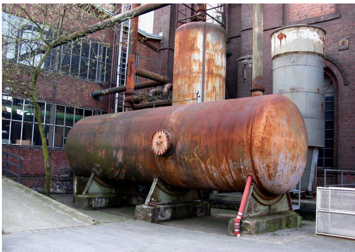
Obrázek 2 - Koroze na tlakové nádobě v průmyslné oblasti [22]
