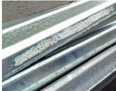
Obrázek 3 - Bílá rez na galvanický pokoveném ochranném zábradlí [24]
