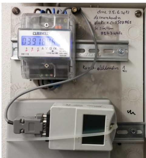
Obr. 4.1 Připojení dataloggeru pro záznam spotřeb el. energie zdroje chladu (foto z měření – budova č. 9)
