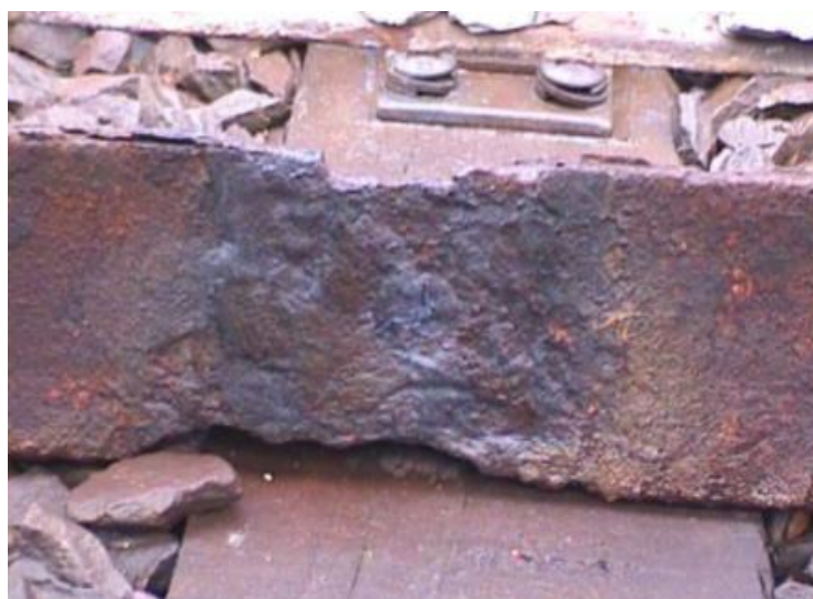
Obrázek 10: Koroze kolejnice způsobená únikem trakčního proudu do země [15]
