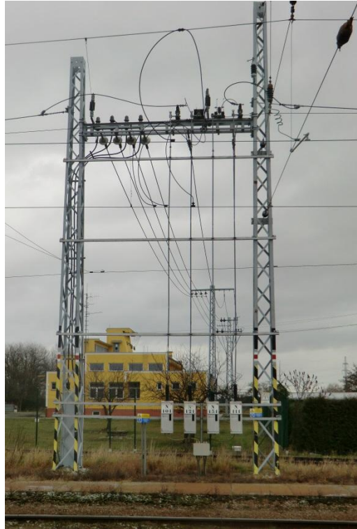
Obrázek 13: Měničrna Malšice a připojení na trakční vedení
