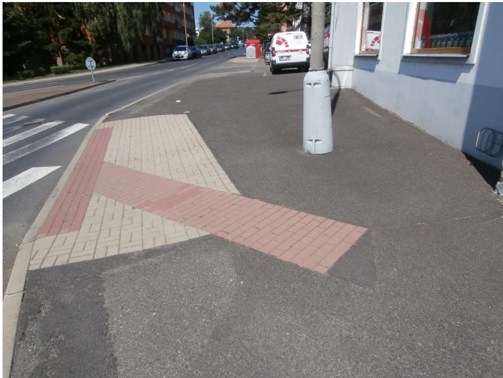
Obrázek 36: Chybně vedený signální pás (Zdroj: vlastní foto)
