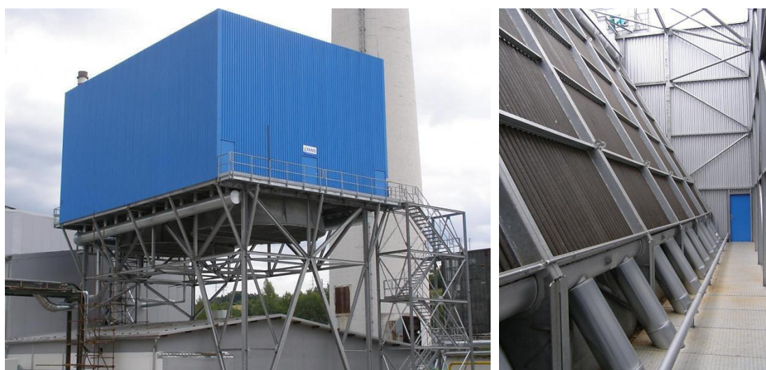
Obr. 5-1: Vzduchem chlazený kondenzátor ve Zvolenu, SK. [21]
