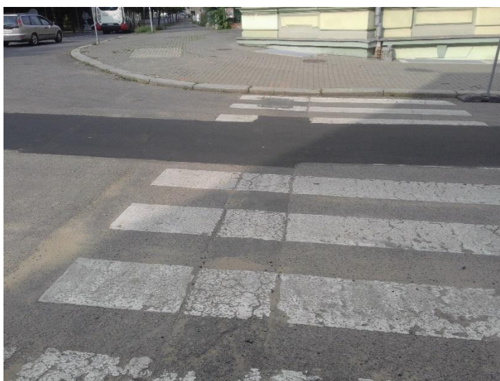
Obrázek 161 Poškozené značení přechodu (zdroj: vlastní fotografie)
