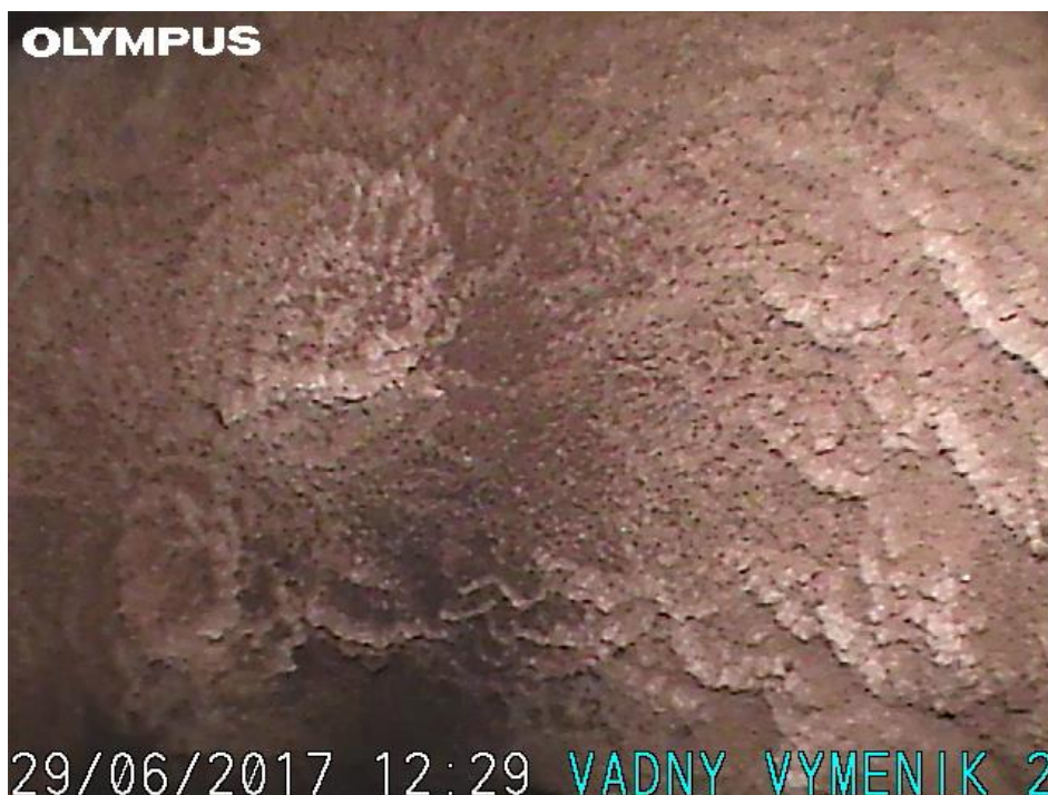
Obrázek 217 – Primární strana výměníku A
