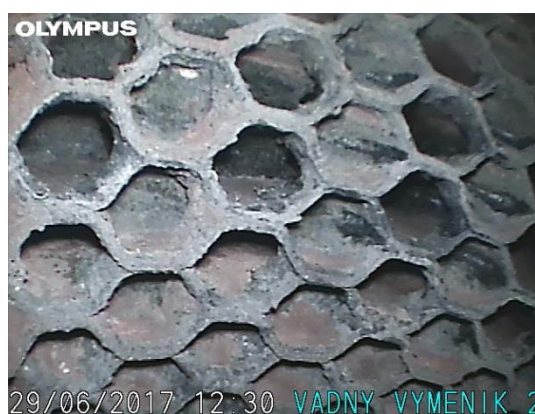
Obrázek 29 – Výstup z primární strany výměníku A
