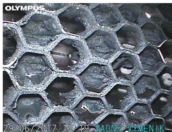
Obrázek 24 – Zanesené kanálky výměníku B
