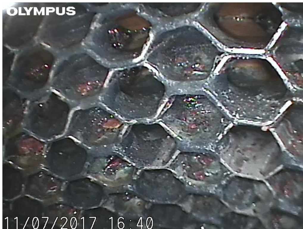
Obrázek 40 – Výměník A po vyčištění (přívodní primární strana)
