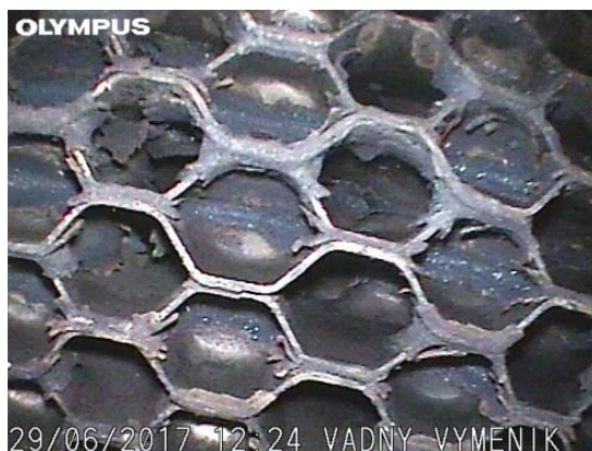
Obrázek 25 – Pohled na sekundární stranu výměníku B
