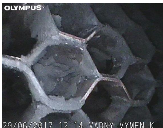
Obrázek 23 – Detail zaneseného kanálku ve výměníku B
