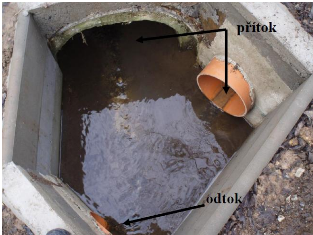
Fotografie 26 – Nevhodně řešená kanalizace v obci Kytín
