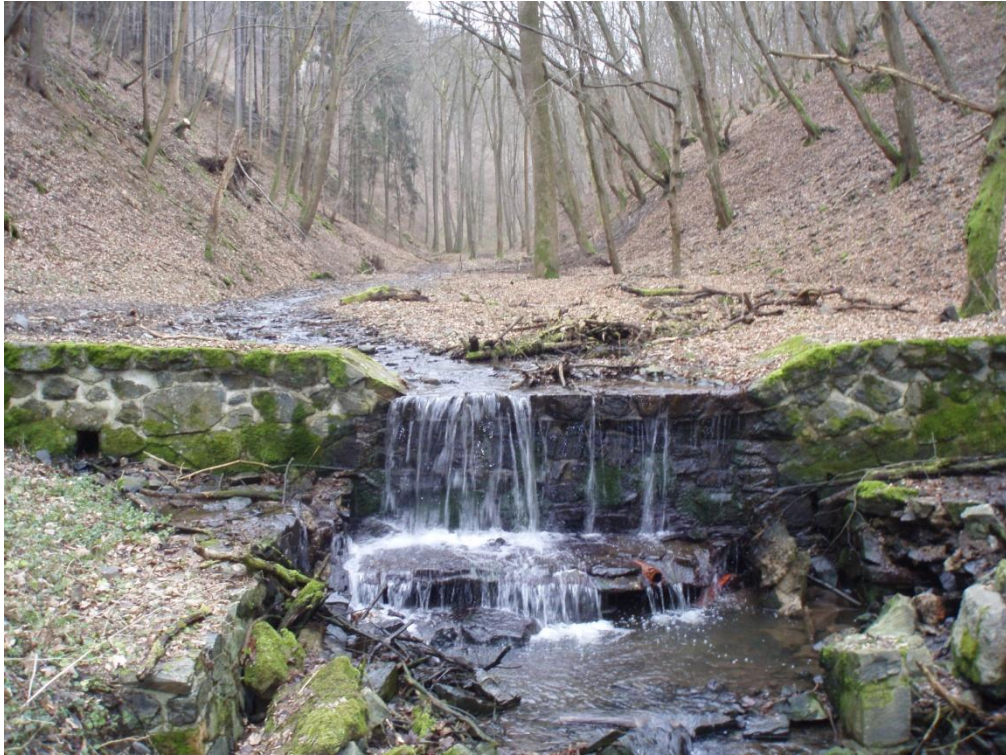
Fotografie 19 – Neudržovaná přehrážka v katastru obce Jiloviště
