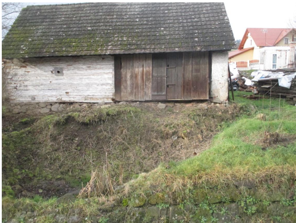
Fotografie 9 – Narušená statika budovy nad vodním tokem v obci Buš
