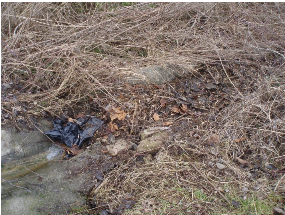
Fotografie 17 – Neudržovaný bezpečnostní přeliv rybníka v obci Hvozdnice
