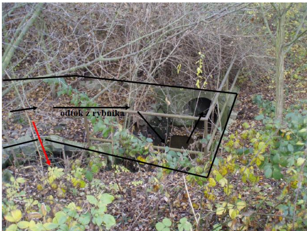
Fotografie 7 – Odtok z rybníka v obci Bratřínov. Červená šipka znázorňuje místo průsaku vody do tělesa hráze.
