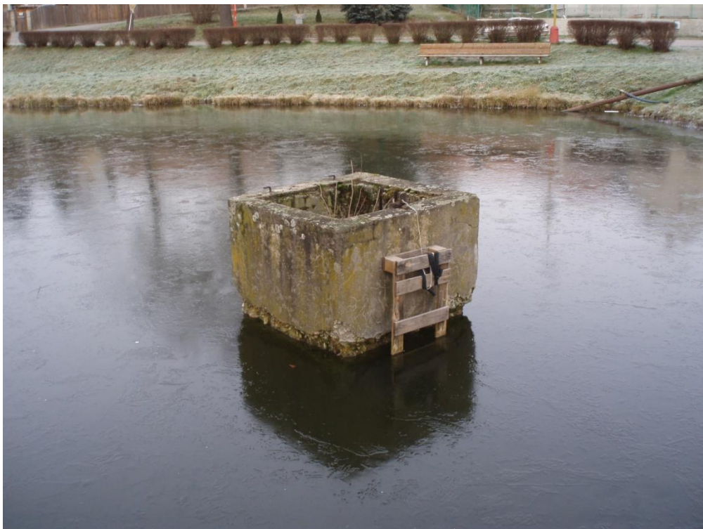
Fotografie 22 – Nezabezpečený vstup k hradítku rybníka v obci Klíneč
