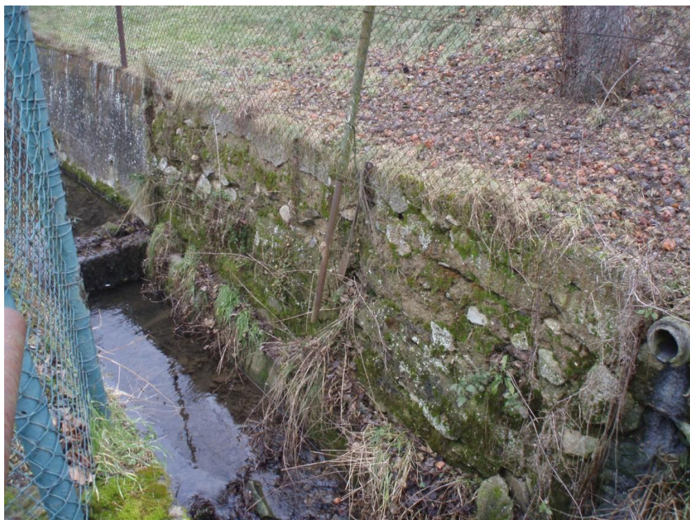
Fotografie 15 – Narušená opěrná zídka plotu v obci Hvozdnice
