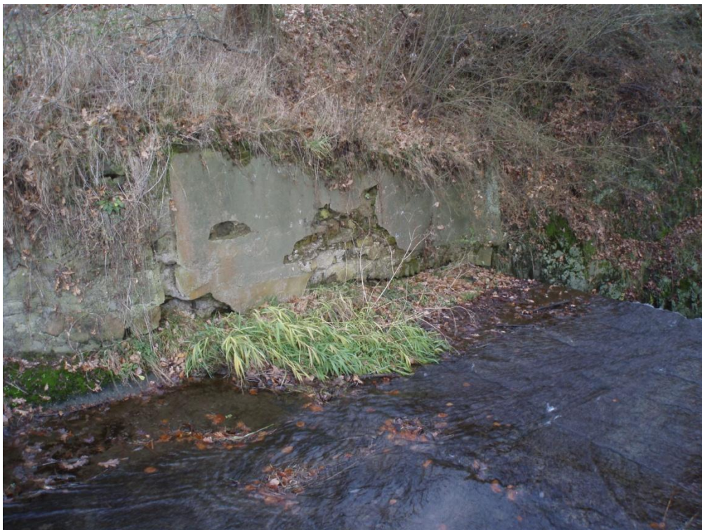
Fotografie 32 – Narušená zeď bezpečnostního přelivu ze Zadního rybníka v Mníšku pod Brdy
