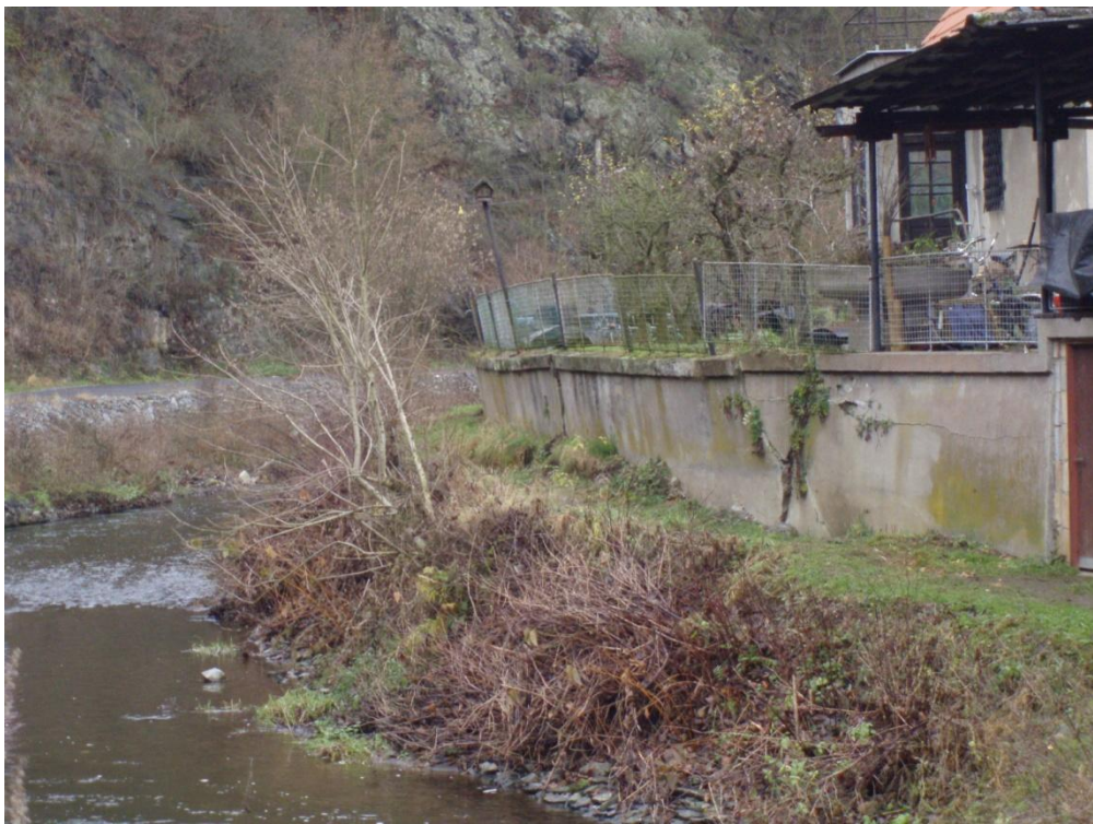
Fotografie 34 – Narušená opěrná zeď plotu v obci Štěchovice
