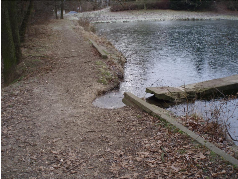
Fotografie 27 – Poškození hráze rybníka „U Spáleného mlýna“ v katastru obce Lišnice
