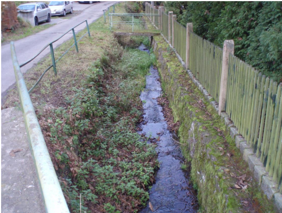
Fotografie 3 – Naplaveniny v korytě potoka v obci Bojanovice
