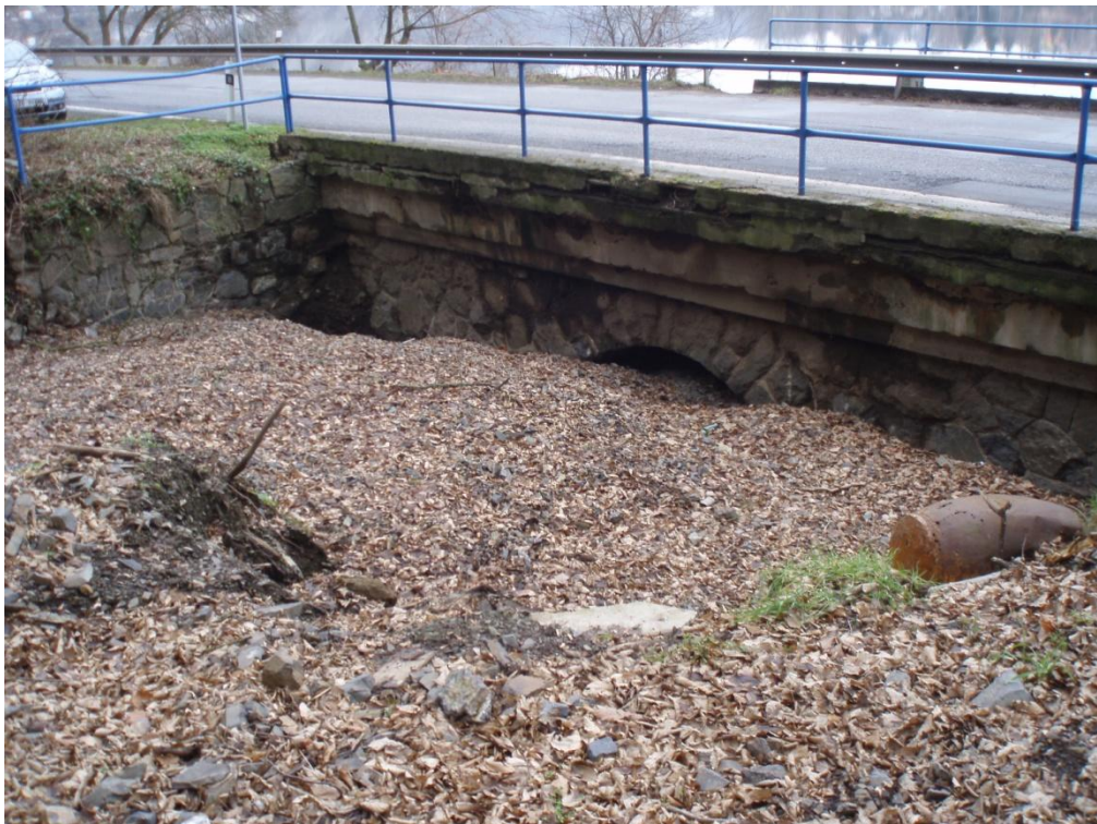
Fotografie 20 – Sesuv horniny poblíž komunikace II. třídy číslo 102, nedaleko obce Měchenice
