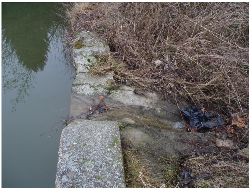
Fotografie 16 – Nedostatečný bezpečnostní přeliv rybníka v obci Hvozdnice
