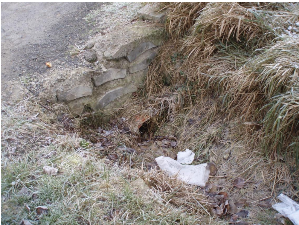
Fotografie 38 – Neudržované kanály a vpustě do odtokových rour v obci Zahořany
