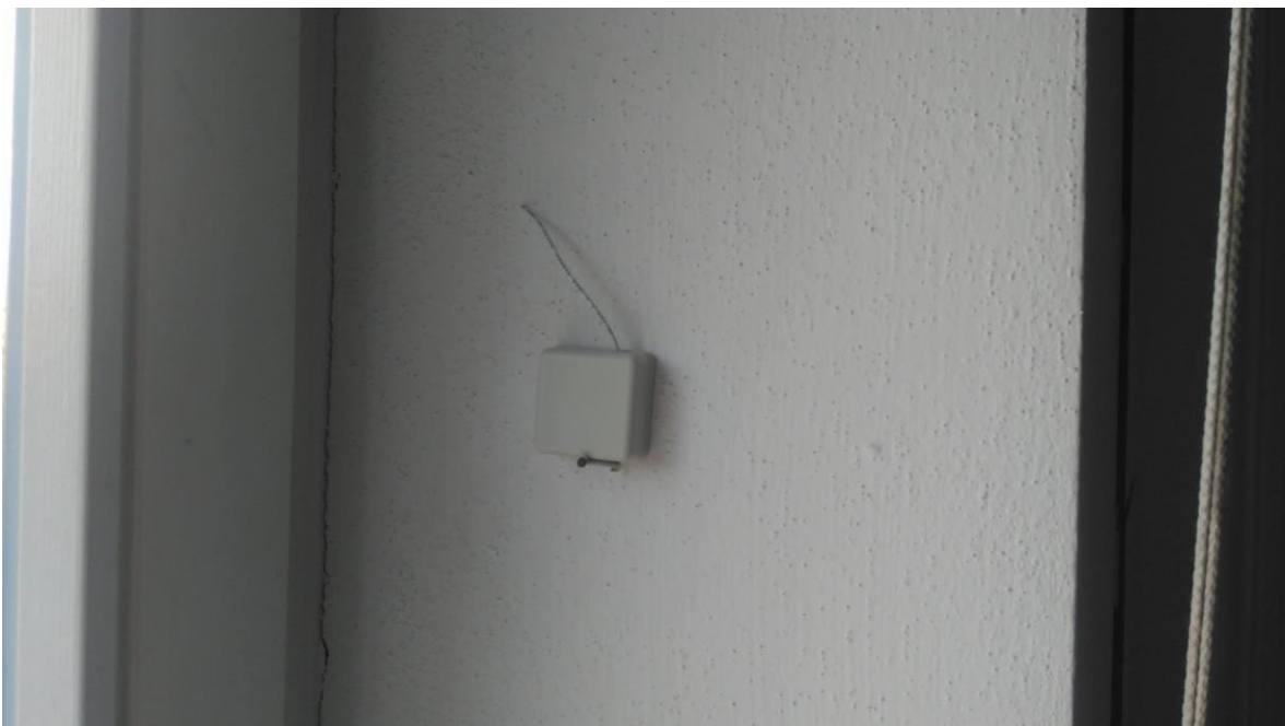
Obrázek 25 Instalované teplotní čidlo
