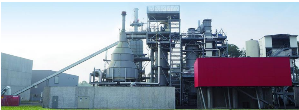
Obr. č. 11: Zařízení CHO Power ve městě Morcenx ve Francii [17]
