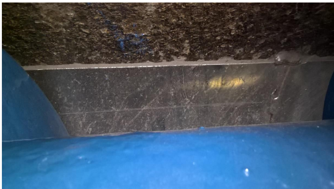
obr. 21.: Nerezová výstelka a nátěr šnekovnice (z archivu autora)
