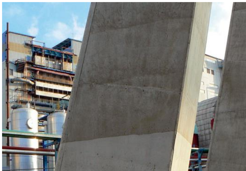
Obrázek 12 - Neodpovídající vyrovnaná barevnost [ https://www.asb-portal.cz/fotogalerie/stavebnictvi/chyby-vznikajici-pri-realizaci-pohledoveho-betonu-fotoalbum/chyby-vznikajici-pri-realizaci-pohledoveho-betonu-5 ]
