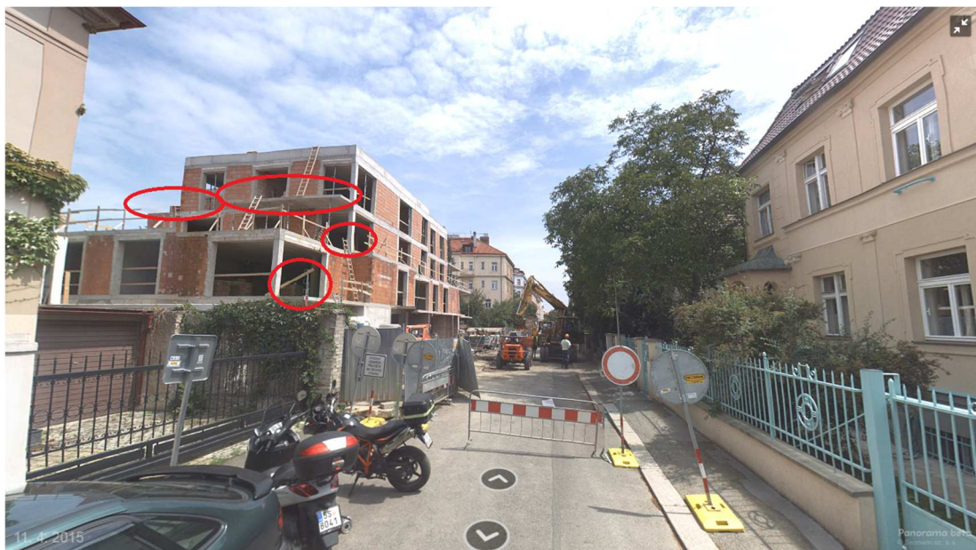
Obr. 20 – Chybí zábradlí (kolektivní ochrana proti pádu z výšky) (9)
