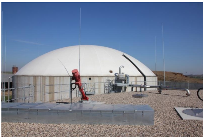
Obr. 10: Fotografie skladovací jímky a plynojemu
