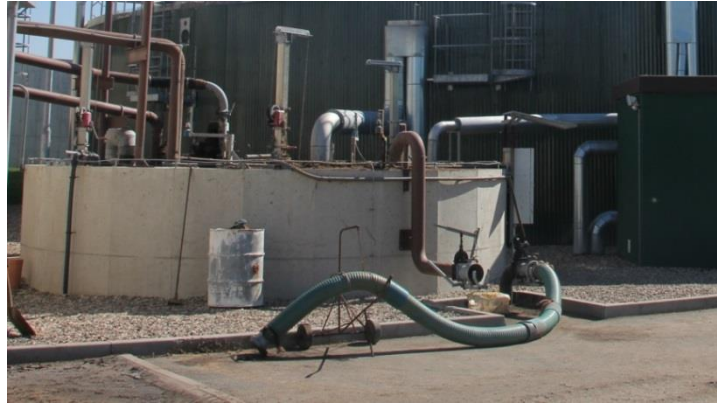
Obr. 7: Fotografie tříkomorové jímky
