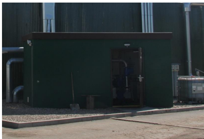
Obr. 6: Fotografie čerpacího centra
