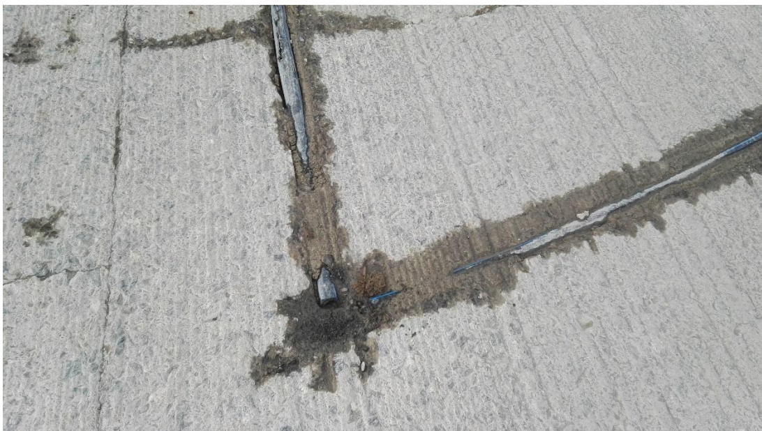
Obr. 11 - Poničené kabelové vedení po frézování [Archiv autora]
