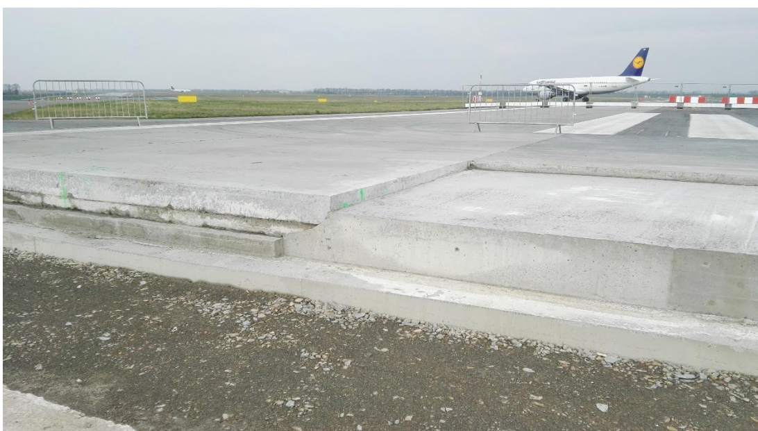
Obr. 9 - Místo napojení dvou etap pojezdové dráhy [Archiv autora]
