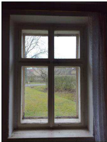
Obr.1: Pohled na okno
