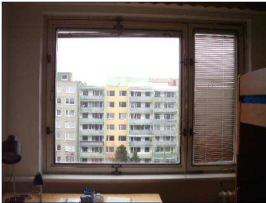
Obr.1: Pohled na okno [10]
