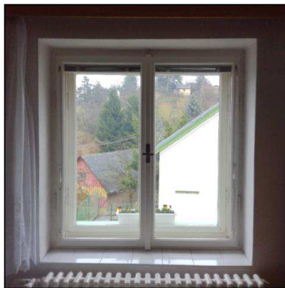
Obr.1: Pohled na okno
