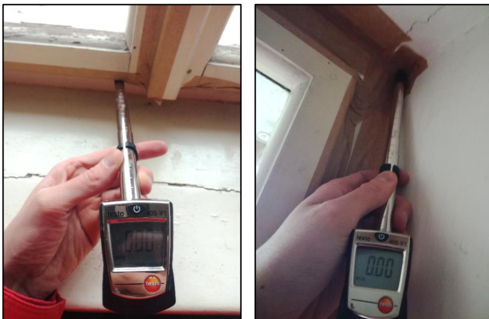
Obr. č.13: Zkouška těsnosti zalepené funkční spáry (vlevo) a zalepené přípojovací spáry (vpravo)
