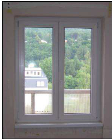
Obr.1: Pohled na okno [10]
