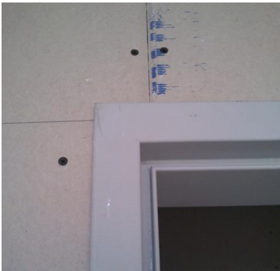
Obr. 37: Nesprávně osazené desky tvořící křížovou spáru v místě rohu otvoru
