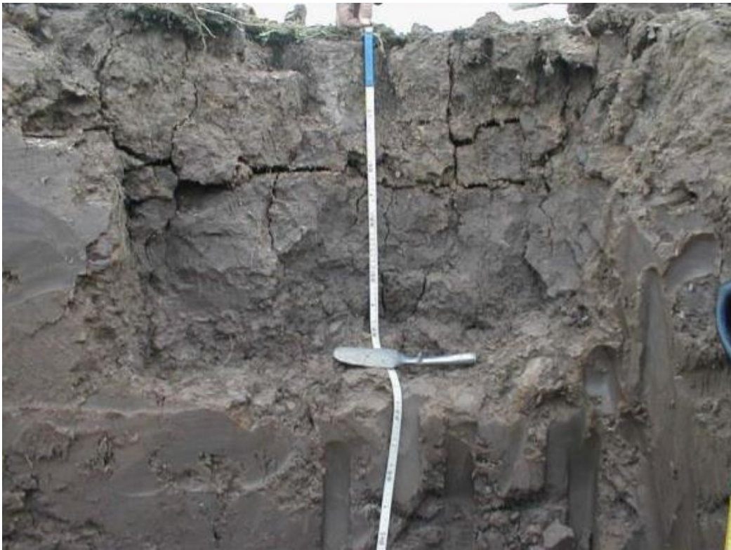
Obrázek 11: Trhliny od vysychání pozorované ve zkušebním výkopu (v hloubce 600 mm pod povrchem) v protipovodňové hrázi Thorngumbald [15]
