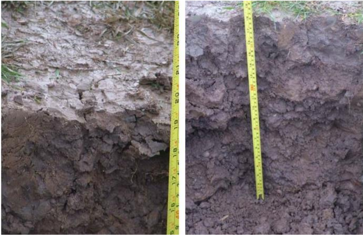
Obrázek 13: Síť trhlin od vysychání pozorovaná v ručně vykopaném zkušebním výkopu na koruně nové hráze [15]
