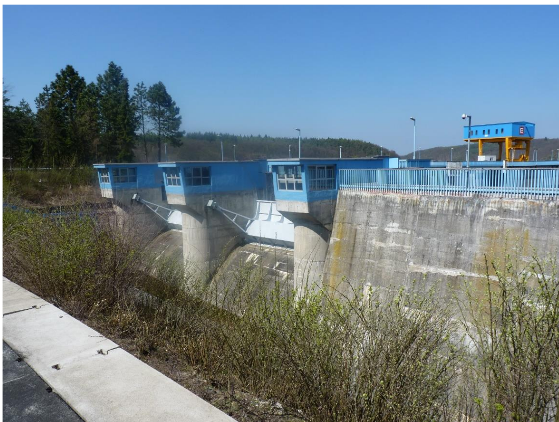
Obrázek 5: Segmentové uzávěry bezpečnostního přelivu (foto autor 10.4.2017)
