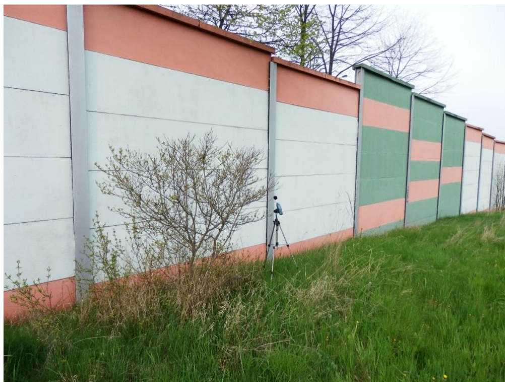
Obr. 32 Umístění měřicí techniky v bodu M5 [autor]
