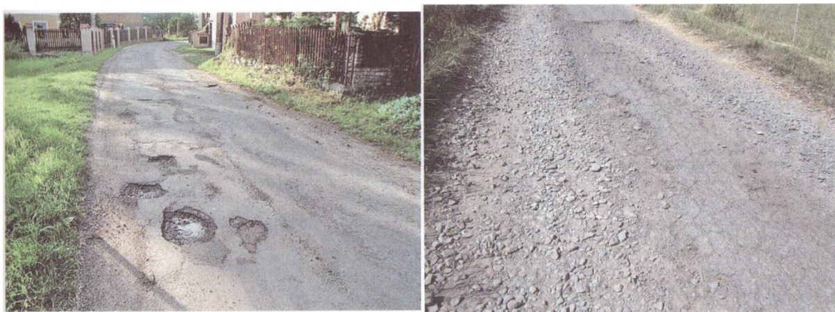
Obrázek 4: Výtluky (vlevo), Rozpad konstrukčních vrstev (vpravo)
