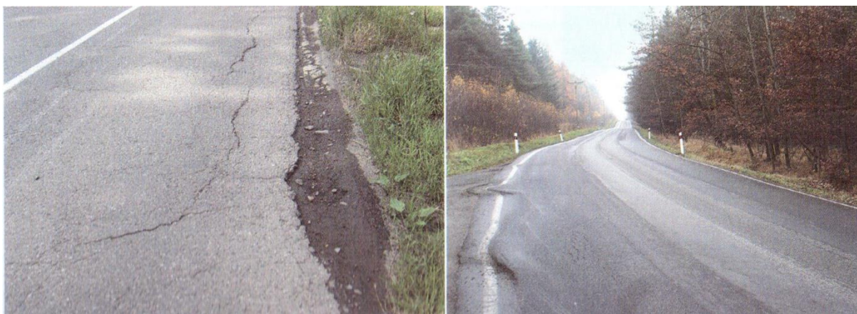
Obrázek 6: Olamování okrajů vozovky (vlevo) a plastické přetváření nekvalitního asfaltového krytu (vpravo)
