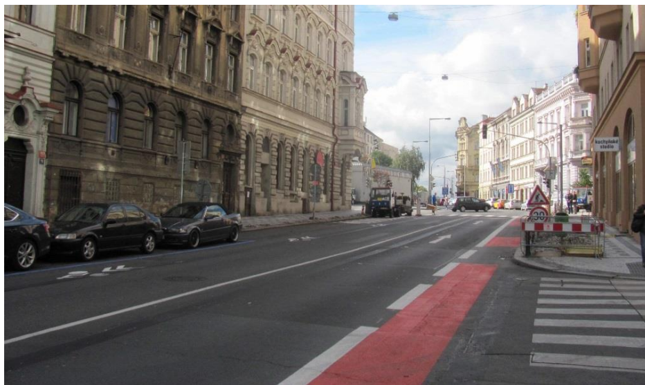
Obrázek 8: Ulice Veletržní při zřizování vyhrazených jízdních pruhů pro cyklisty a cyklistický piktokoridorů [21]
