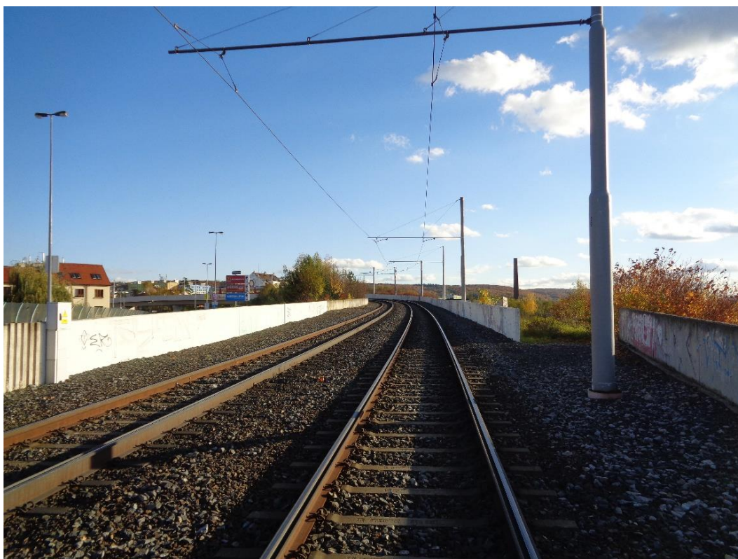
Obrázek 3 - Místo plánovaného odbočení trati do Komořan (koleje 2). Kolej 1 se k trati do Braníka připojí sjezdovou výhybkou umístěné u jižního začátku opěrné zdi do koleje opačného směru jízdy
