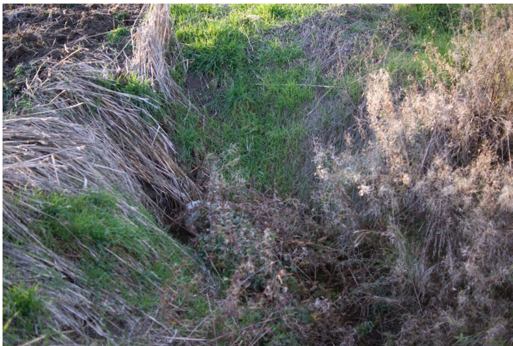
Obrázek č. 6.50 – poškozené odvodnění
