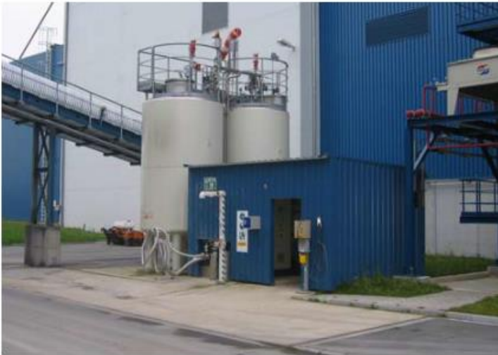
Obrázek 2-14 Nádrže a stáček stanice pro čpavkovou vodu (9)
