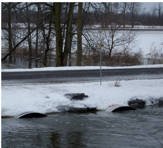
Obr. 10 Volný vtok do propustku během povodní
