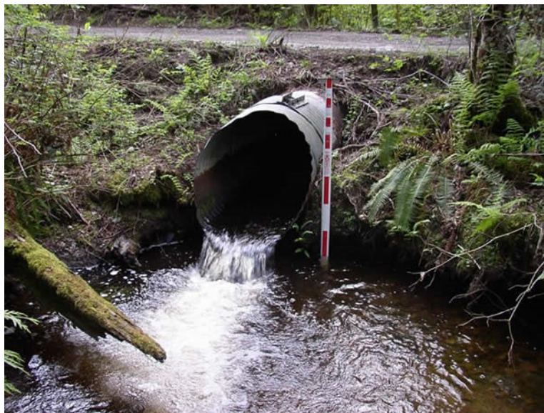
Obr. 5 Ekologicky nevhodné řešení výtoku propustku
