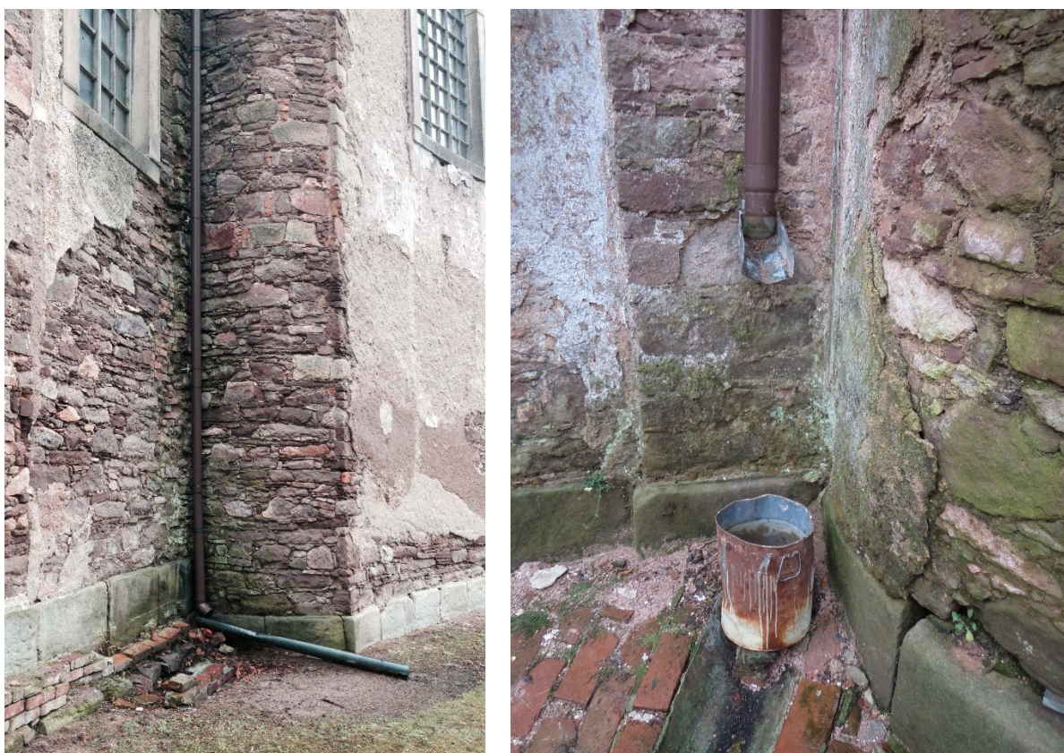
Obrázek 42 – ukázky současného řešení odtoku z okapů
