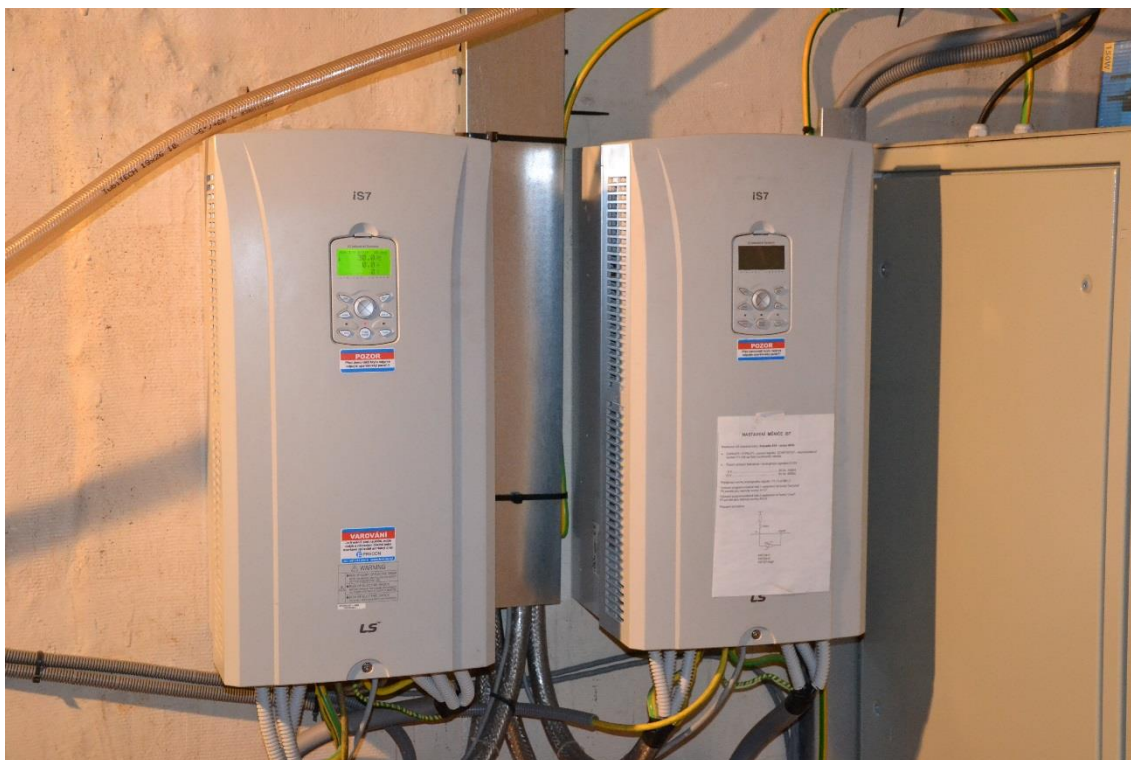
Obr 3.3 frekvenční měniče čerpadel
