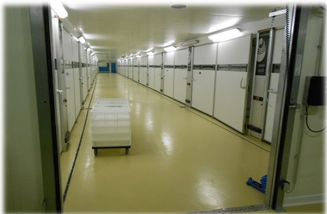
Obrázek 22 - Fotografie části technologie líhně brojlerů
