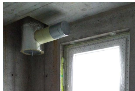
14. Zaslepené rozvody vzduchotechniky
