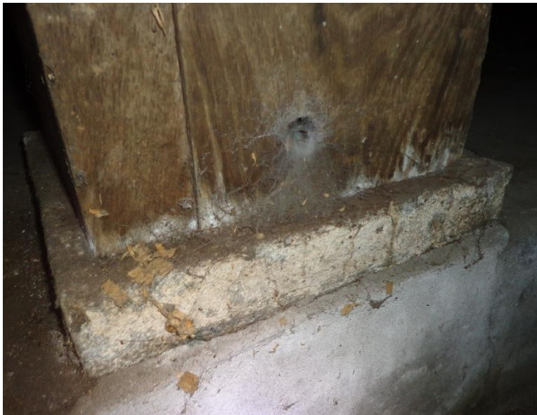
Obr. č. 30 _ Sloup zasažený plísní -suterén. (vlastní zdroj)
