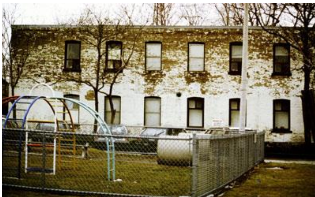
Obr. 1 – Důsledek netěsných obvodových konstrukcí budovy vlivem kondenzace vlhkosti exfiltrujícího vzduchu na vnější straně obvodových stěn. Obr. převzat z [15].
