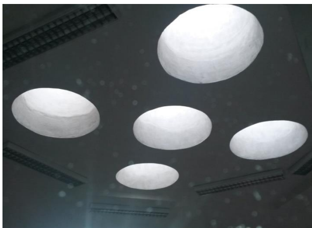
Obr. 3.4. Pohled na střešní světlíky z interiéru – Fotografie pořízená při prohlídce objektu (listopad 2016)
