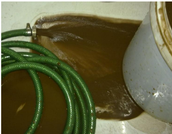
Obr. 1.38 Znečištěná topná voda v podlahovém systému vytápění (autor)
