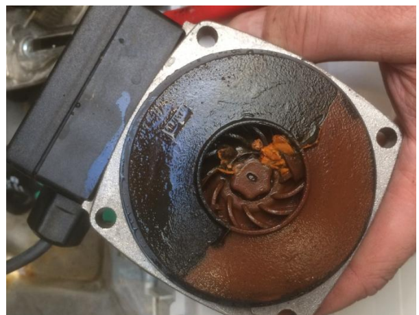
Obr. 1.39 Nečistoty v oběhovém kole čerpadla (autor)
