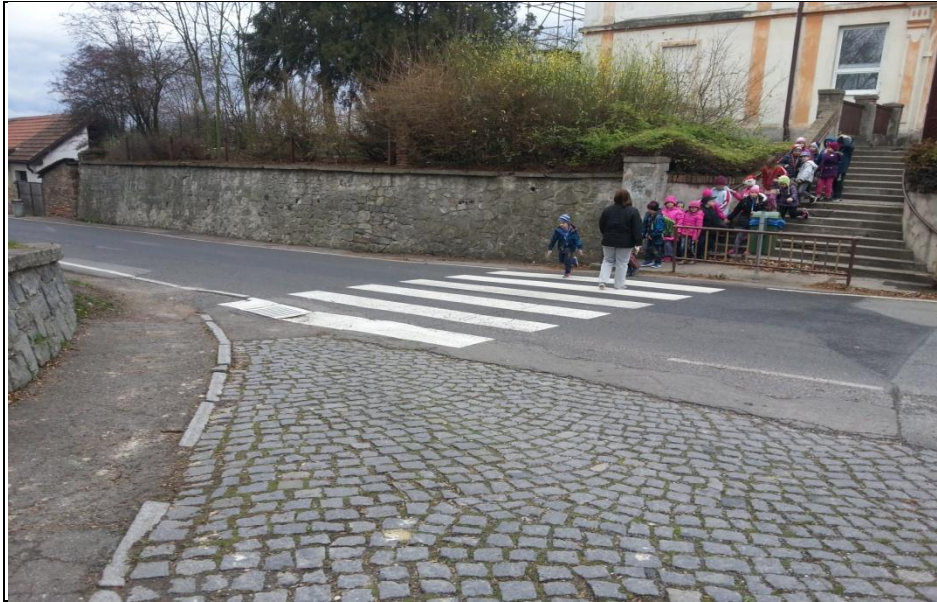
Obrázek 27 Špatně provedený přechod pro chodce před školou
