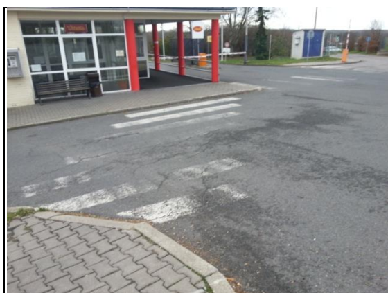
Obrázek 7 Špatně viditelné VDZ V7 (Přechod pro chodce) a absence OOSPO Zdroj: Autor
