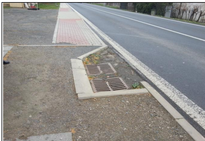
Obrázek 13 Špatné umístění kanalizačních vpustí
