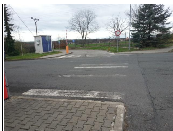
Obrázek 8 Špatně viditelné VDZ V7 (Přechod pro chodce) a absence OOSPO Zdroj: Autor
