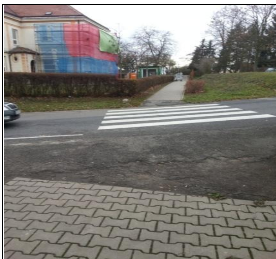
Obrázek 16 Nesprávně napojen a proveden přechod pro chodce
