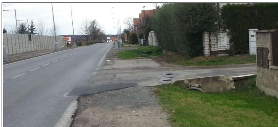
Obrázek 9 Nebezpečný trubní propustek
