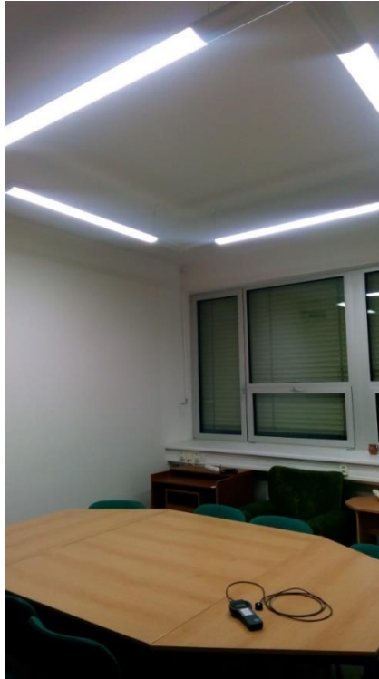
Obr. č. 26 – Měřená místnost – konzultační místnost T2: B3-355 v areálu ČVUT v Dejvicích
