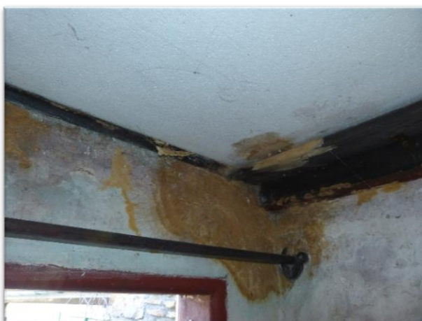
Obr. 32: Dřevěný strop nad místností 109 – biologické napadení [Vytvořeno autorem]
