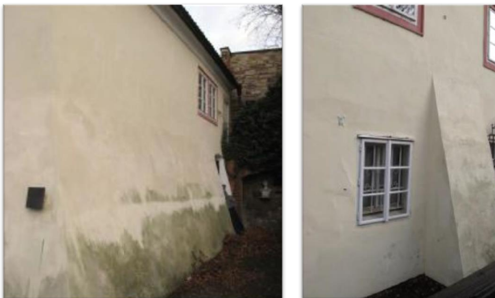
Obr. 33: Vzlínající vlhkost, zelená řasa a hyroskopické mapy na JV fasádě (vlevo) [Vytvořeno autorem]
