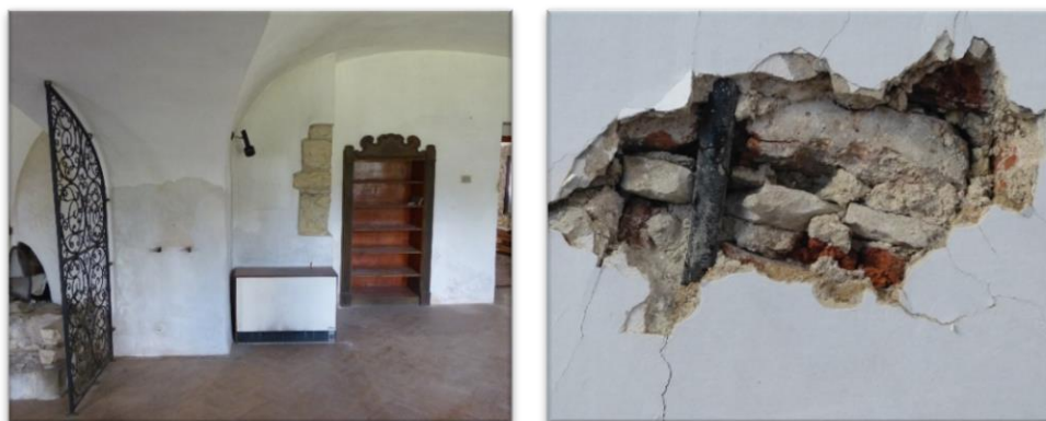
Obr. 7: Valená klenba v 1.NP v místnosti č. 106 (vlevo) [Vytvořeno autorem]
