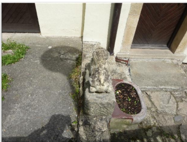
Obr. 28: Zaústění dešťového svodu pod terén – JZ průčelí [Vytvořeno autorem]
