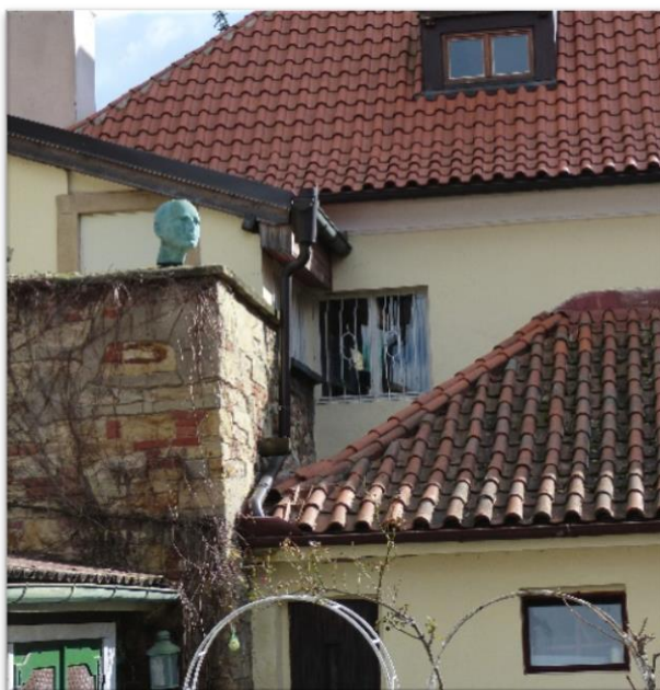
Obr. 30: Úžlabí mezi střechou garáže a zdí [Vytvořeno autorem]
