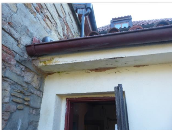
Obr. 31: Římsa na přístavbě garáže – biologické napadení [Vytvořeno autorem]
