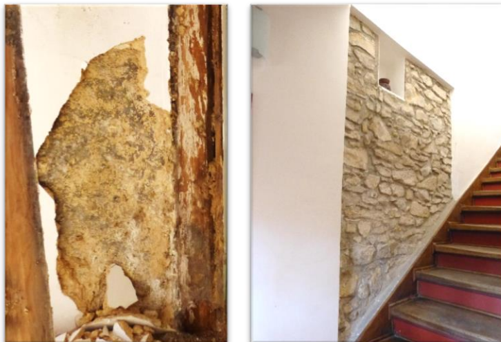
Obr. 5: Zdivo v místě opadané omítky (vlevo) [Vytvořeno autorem]
