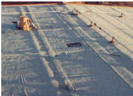
Obr. 31 - Poškození pásu přehřátím (foto firmy DEK s.r.o.)
