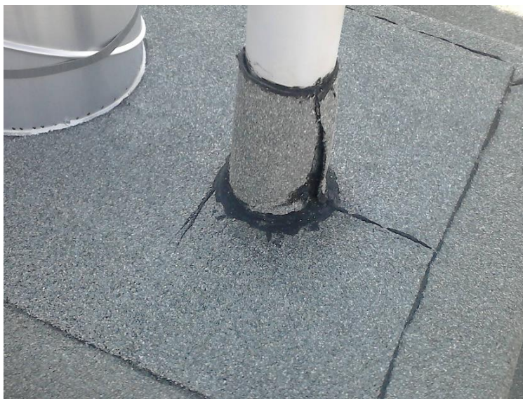
Obr. 33 - Chybně provedený detail z asfaltového pásu (foto firmy Folk s.r.o.)
