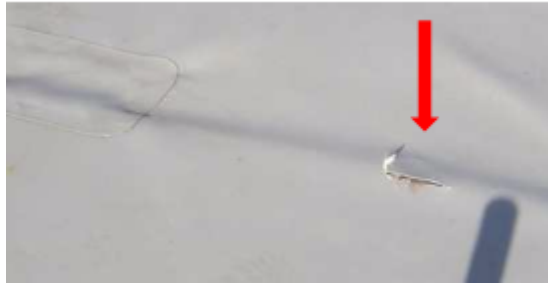
Obr. 36 - Mechanické poškození hydroizolačního povlaku (převzato z [7])
