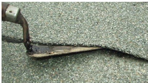
Obr. 30 - Nedostatečně svařený hydroizolační povlak (foto firmy DEK s.r.o.)
