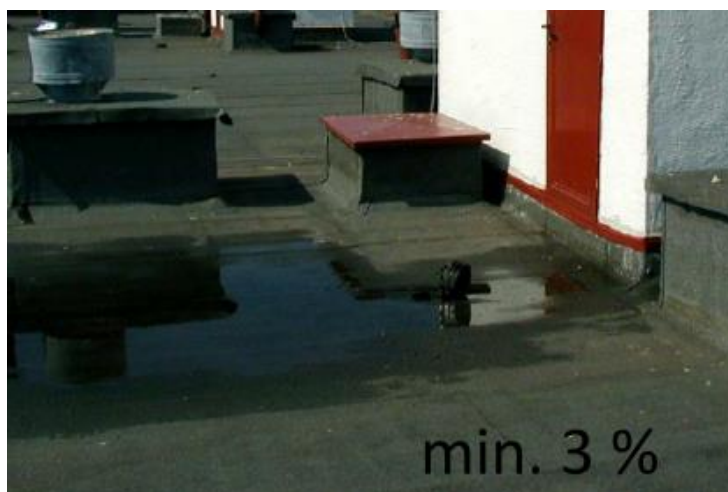
Obr. 29 - Tvorba louží na nesprávně vyspárované střechy (foto firmy DEK s.r.o.)
