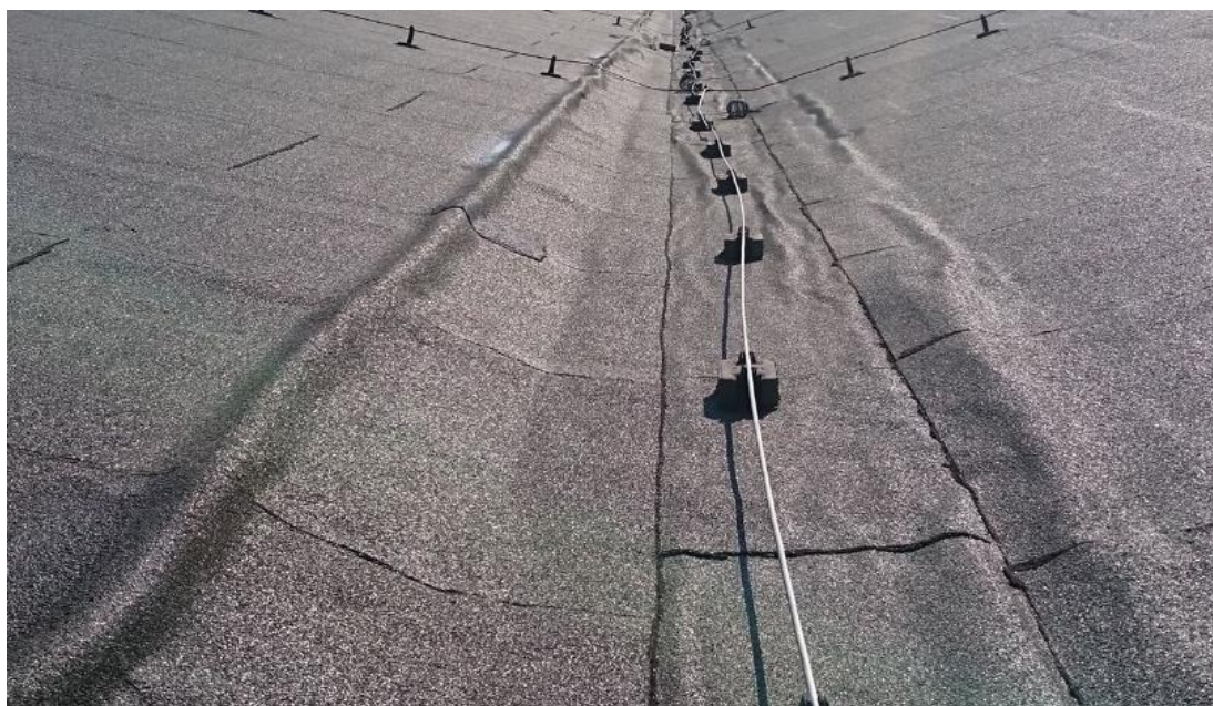
Obr. 41 - Podélná vlna u odvodňovacího žlabu (foto autor)
