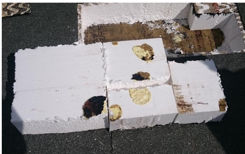
Obr. 42 - EPS desky nedostatečně přilepené a s vytvrdlým lepidlem (foto autor)
