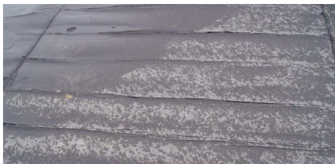
Obr. 32 - Popraskaný oxidovaný pás po rozbalení za chladu (foto firmy DEK s.r.o.)
