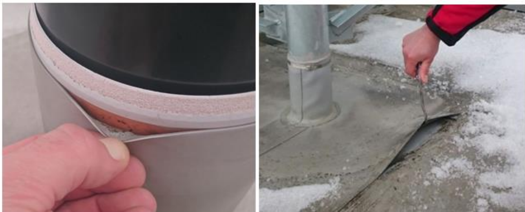
Obr. 38 - Chybně provedené detaily (foto firmy Folk s.r.o.)
