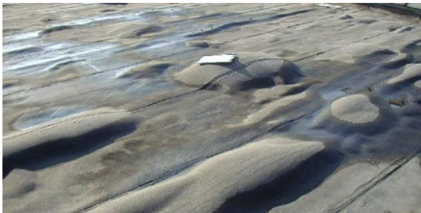
Obr. 28 - Boule na asfaltovém hydroizolačním povlaku (foto firmy DEK s.r.o.)
