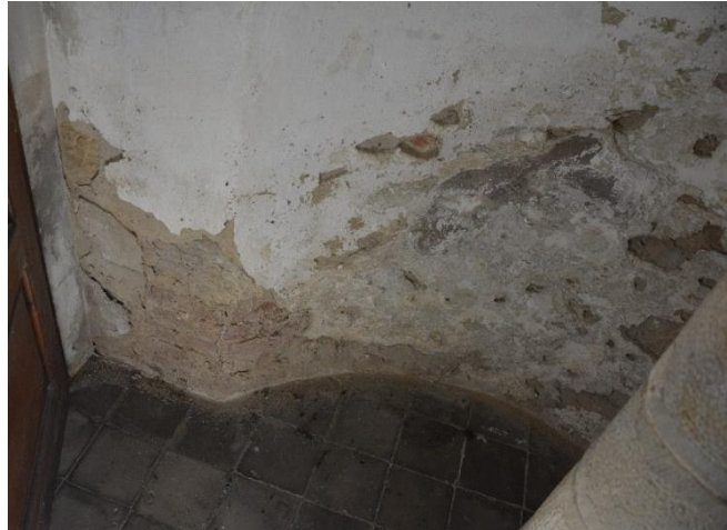
Obr. 44: Vzlínající vlhkost u bočního vchodu na kůr
