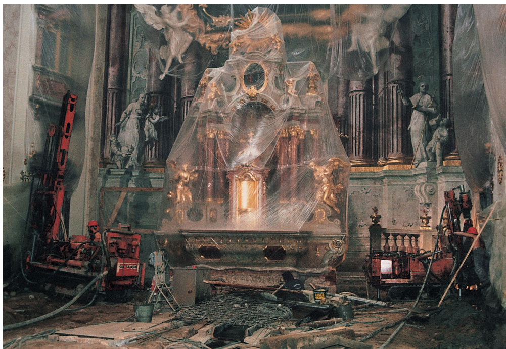
Ukázky podchycování základů u historických objektů (Kostel sv. Františka Xaverského, Uherské Hradiště)
