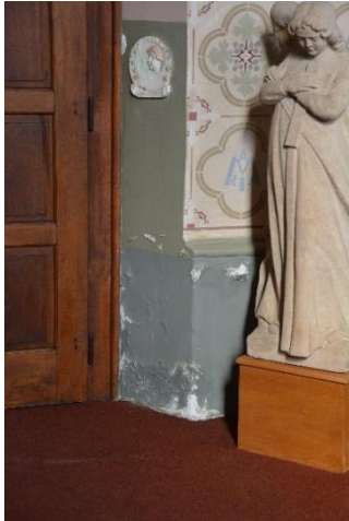
Obr. 43: Vzlínající vlhkost v hlavní lodi
