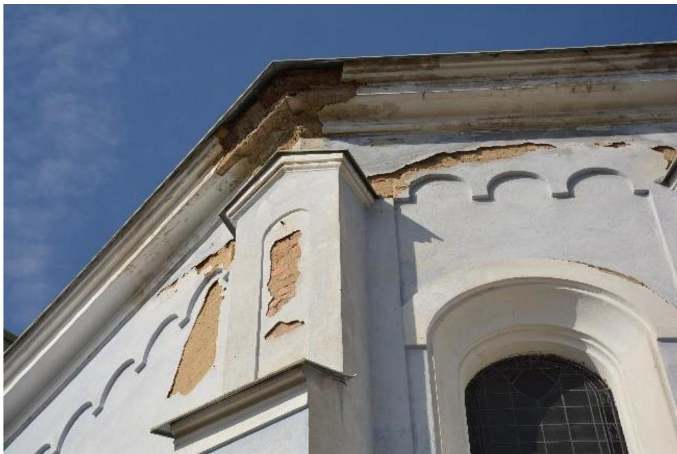
Obr. 48: Zatečená voda a opadaná omítka
