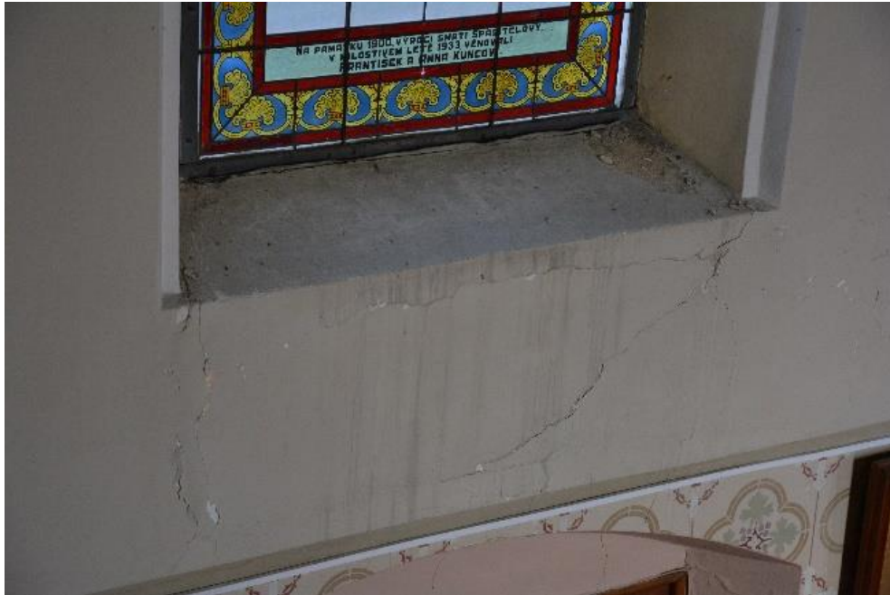
Obr. 46: Srážková voda protékající přes okenní rámy
