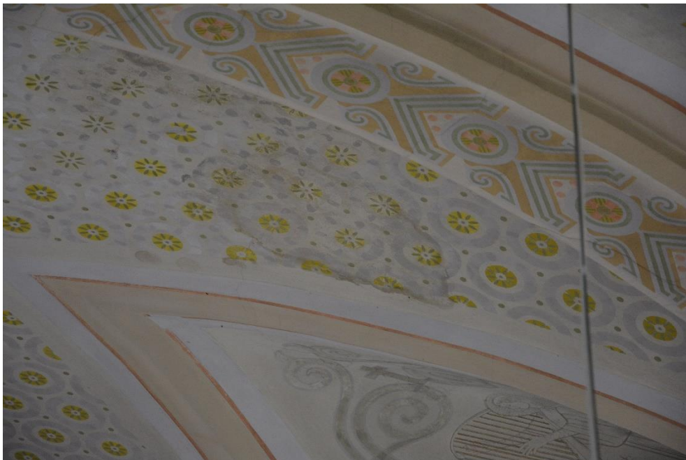
Obr. 45: Zatečená voda ve stropě
