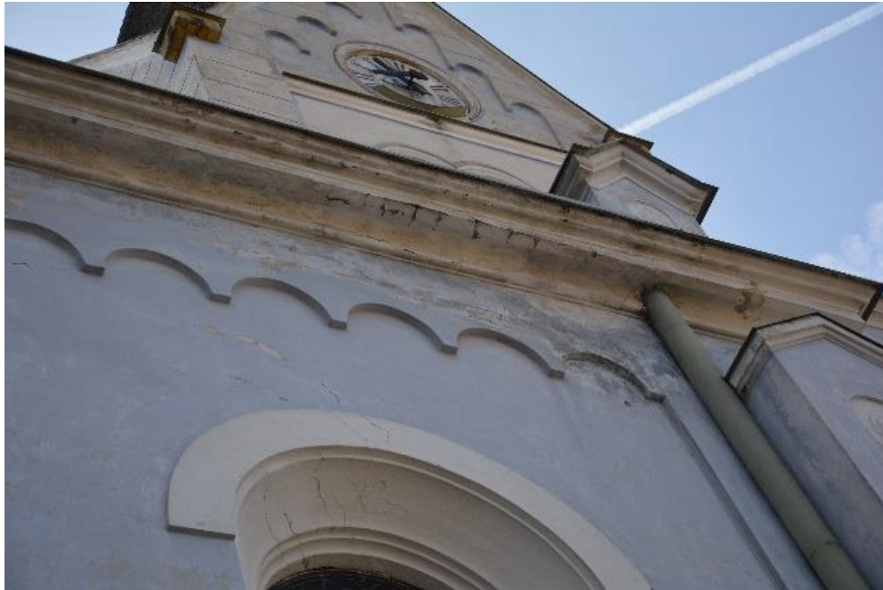
Obr. 47: Zatečená srážková voda
