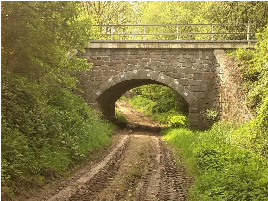
Fotografie č. 1 - Podjezd pod železniční tratí – křížení přístupové cesty od Pastuhovic se železnici.
