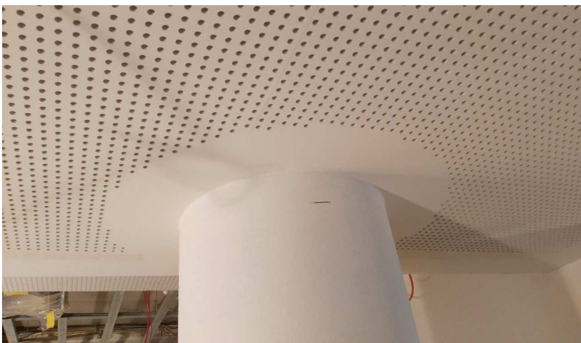
Obrázek č. 14: Pohled z akustických sádrokartonových desek. Správně je řešen okraj podhledu, kde je použita deska bez akustického děrování (Převzato z osobního archivu)
