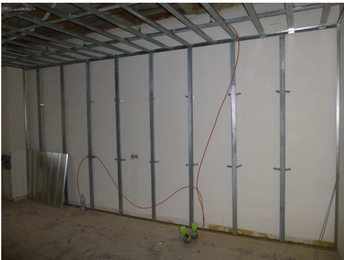
Obrázek č.9: Připravený rošt pro opláštění spřažené předstěny a podhledu (Převzato z osobního archivu)
