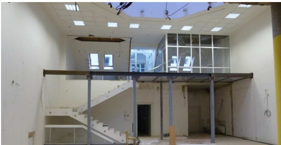
Obrázek č.16: Pohled na nosnou ocelovou konstrukci, kde bude realizována bezpečnostní příčka (Převzato z osobního archivu)
