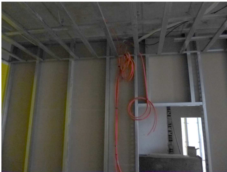
Obrázek č. 6: Kovový rastr po prvním opláštění příčky, dokončený rošt pro podhled (Převzato z osobního archivu)
