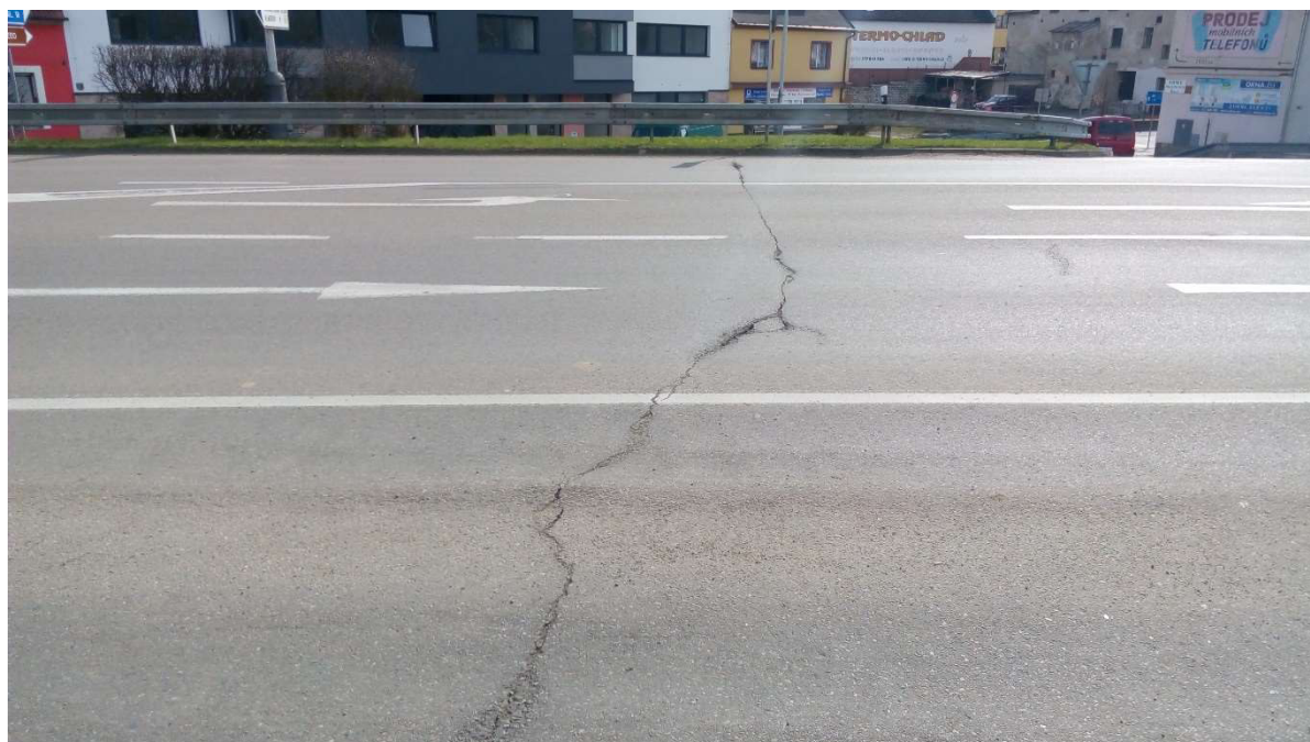
Obrázek 15 – ulice Tř. Politických vězňů, porucha vozovky
